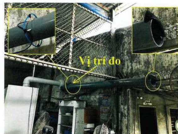
Đo độ mất áp trên đường ống thải
