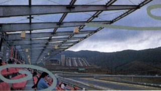
台風で吹き飛んだグランドスタンドの屋根はそのままレースを迎えた。幸い決勝日には雨が降らなくてヨカッタ、ヨカッタ
