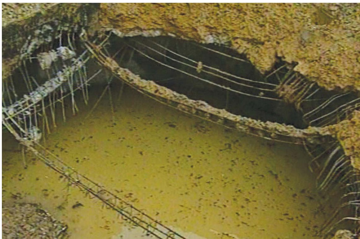
Слика 49. Уништен резервоар за воду у Лукавици
