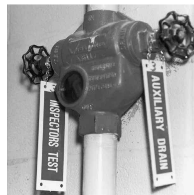
Figura 15.47 La válvula de prueba del inspector está equipada con un orificio del tamaño de un rociador y se utiliza para simular la activación de un rociador.
