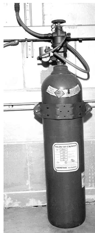
Figura 5.11 Tanque de halón 1301 en un sistema fijo.
