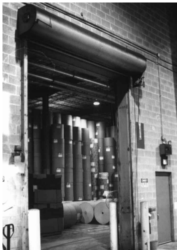
Figura 8.40 Puerta cortafuegos de acero enrollable ascendente.
