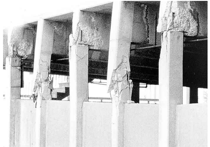
Figura 7.92 Los garajes de aparcamiento son estructuras propensas al hundimiento.
