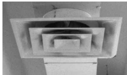
Figura 10.15 Los conductos del aire acondicionado pueden propagar los productos de la combustión por la estructura.
