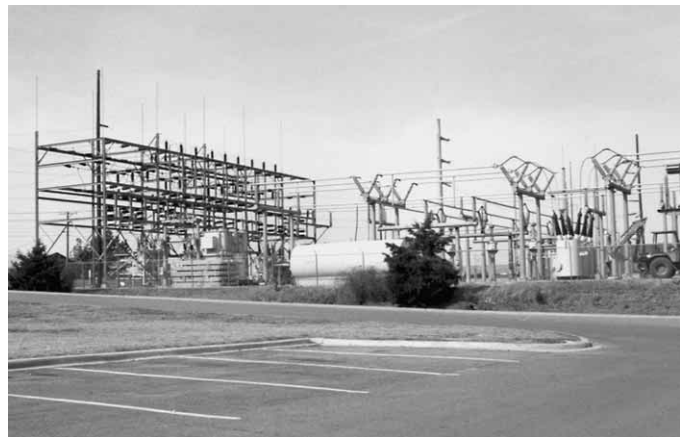
Figura 14.31 Los incendios en las subestaciones eléctricas son algunas de las emergencias eléctricas que los bomberos se encuentran habitualmente.
