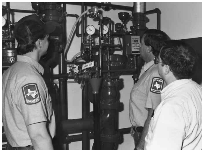
Figura 15.53 Personal del cuerpo de bomberos realizando una inspección del sistema de rociadores de un edificio para un plan de actuación normalizado.
