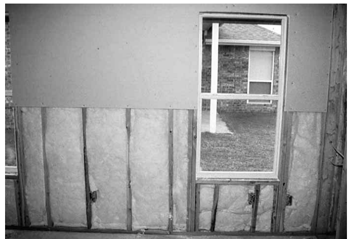
Figura 3.15 Las placas de yeso se utilizan para cubrir los muros interiores.
