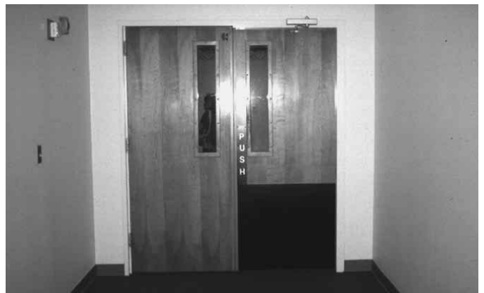
Figura 8.39 Las puertas de incendios con dos batiente, habituales en los pasillos de los centros comerciales, se cierran automáticamente cuando se activan los sistemas de alarma.
