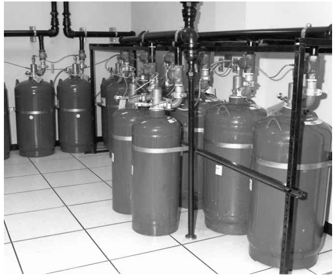
Figura 14.30 El halón suele utilizarse en incendios de clase C.
