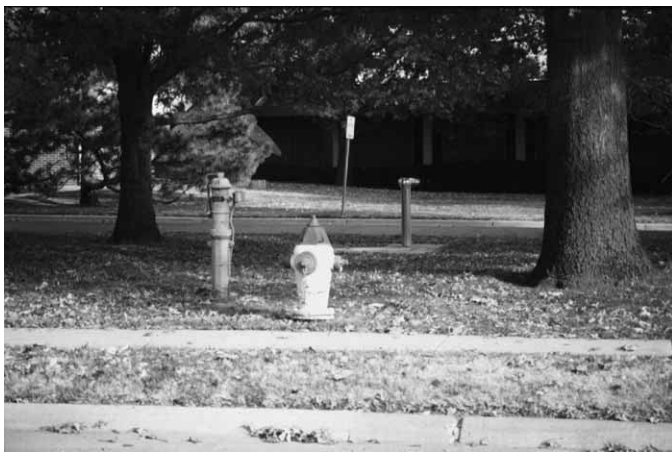
Figura 19.18 Los bomberos deben apuntar la ubicación de los hidrantes, las conexiones de los rociadores y las válvulas de control de agua durante una inspección.
