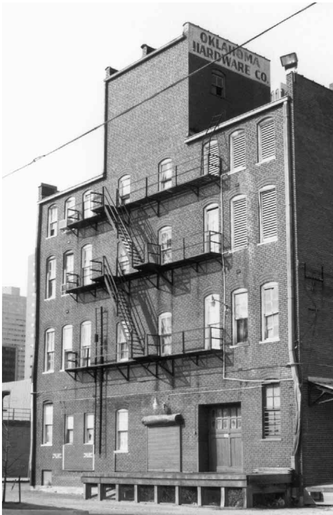
Figura 10.10 Fíjese en la disponibilidad y el estado de las salidas de emergencia.
