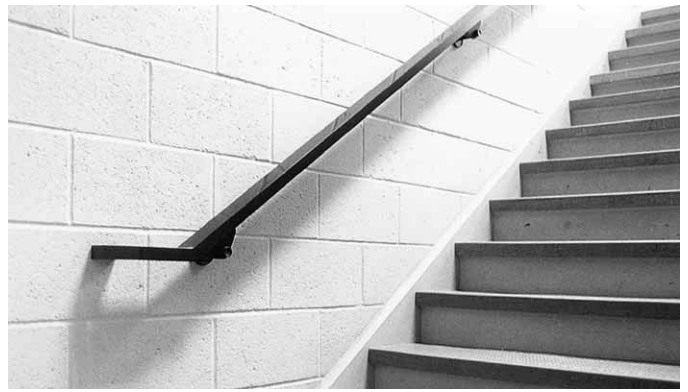
Figura 7.9 Las escaleras de salida deben estar despejadas de peligros
