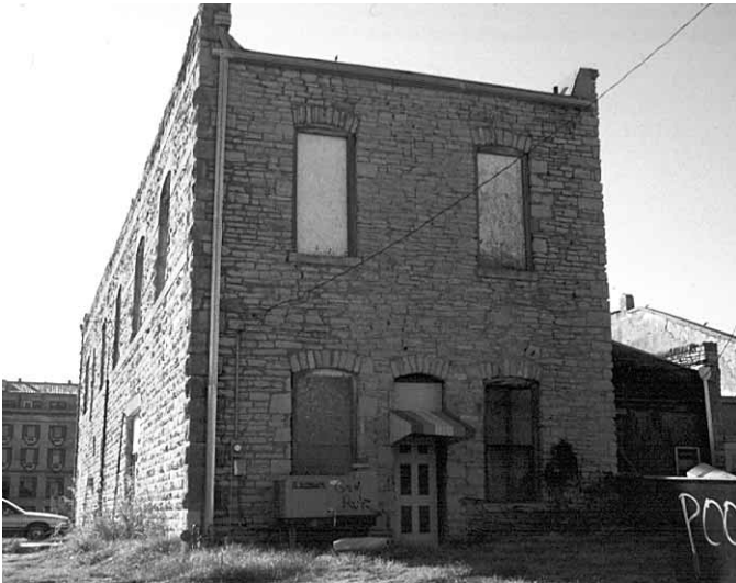
Figura 3.21 Los edificios antiguos pueden resultar muy peligrosos durante los incendios.
