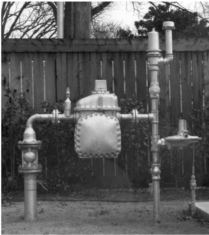
Figura 14.28 Medidor de gas natural.
