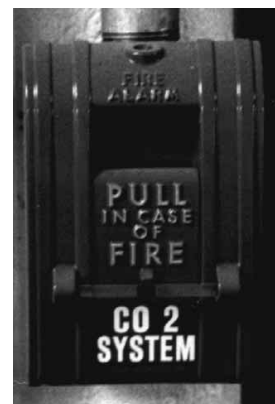
Figura 15.30 Pulsador manual que inicia una alarma y activa el sistema de extinción de incendios.
