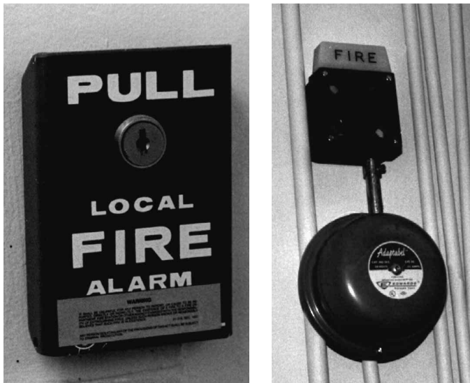
Figura 15.1 Los dos componentes de un sistema de alarma local.
