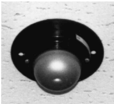
Figura 15.7 Detector termovelocimétrico local.
