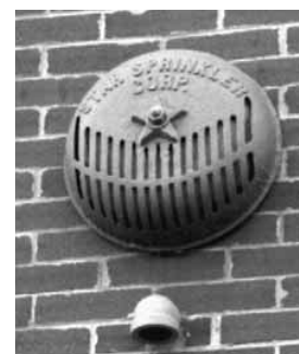
Figura 15.48 Las alarmas de flujo de agua advierten de que el agua se está moviendo por el sistema.
