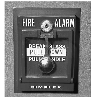
Figura 18.20 Estación de alarma de incendios que suele encontrarse en muchas instalaciones.
