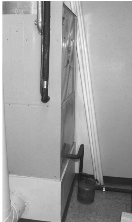
Figura 19.6 Busque riesgos evidentes como este contenedor de líquido inflamable situado al lado de un calentador.
