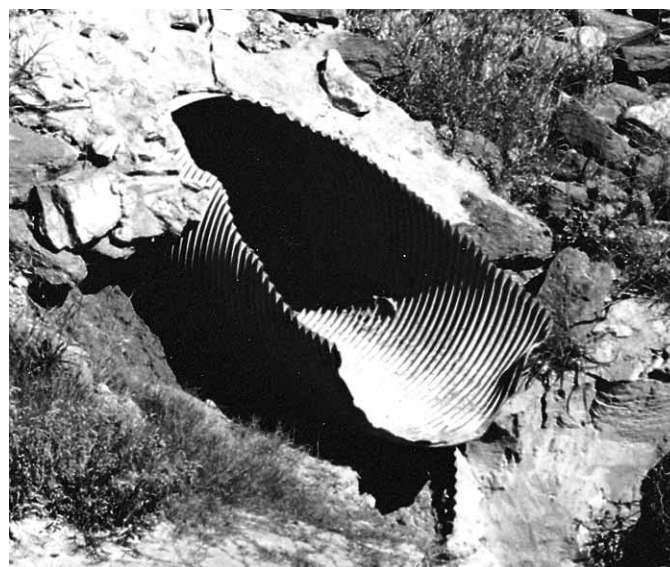
Figura 4.31 Las alcantarillas y los desagües son espacios limitados que requieren el uso del aparato de respiración.
