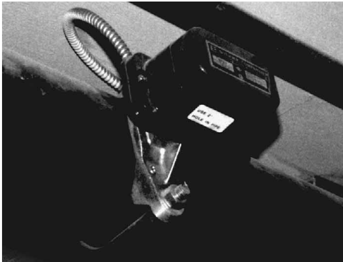
Figura 15.31 Dispositivo de alarma del flujo de agua.
