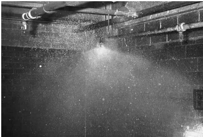
Figura 15.32 Rociador en funcionamiento.
