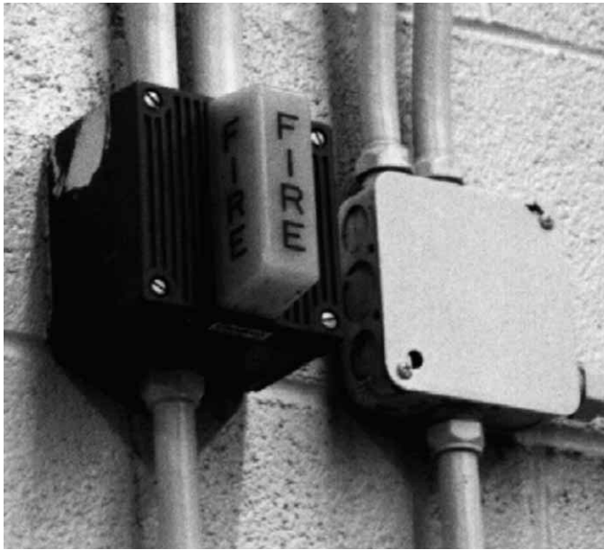
Figura 15.20 Dispositivo de alarma con destellos para la evacuación.
