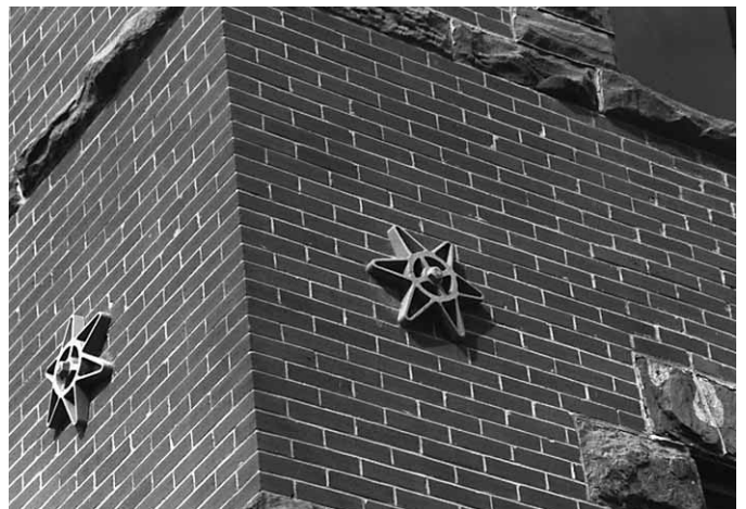
Figura 3.23 Las estrellas de refuerzo en un edificio indican que el edificio ya se encontraba en mal estado antes del inicio del incendio.
