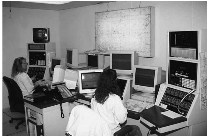
Figura 18.1 El centro de telecomunicaciones es el centro neurálgico de la respuesta de emergencia.
