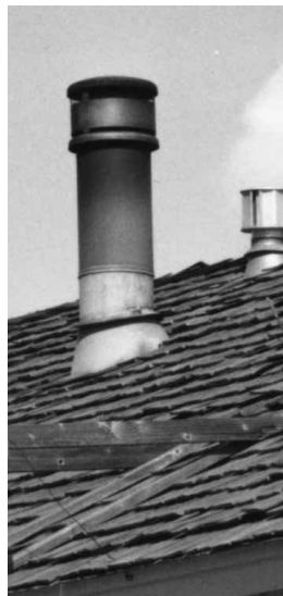
Figura 19.31b La mayoría de chimeneas nuevas son de metal o prefabricadas.
