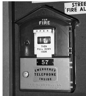
Figura 18.19 Aparato municipal de alarma contraincendios.
