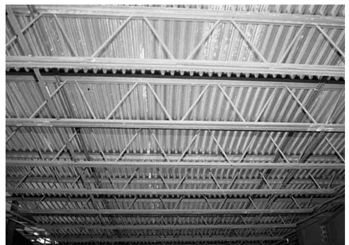
Figura 3.26 Las armaduras de acero ligeras sin protección se quiebran rápidamente al exponerse a un calor elevado.
