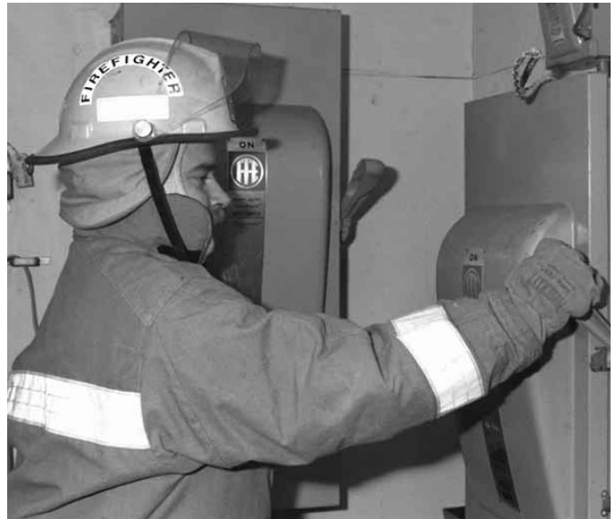
Figura 14.35 El bombero debe controlar la energía del panel abriendo el interruptor principal.
