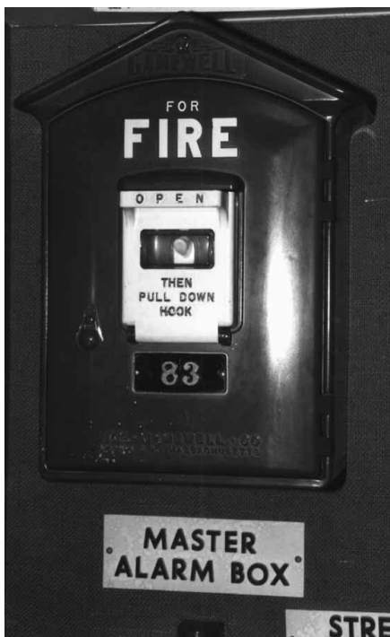
Figura 15.21 Sistema maestro de alarma municipal.
