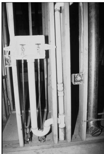
Figura 8.80 No rompa muros que contengan obstrucciones como tuberías de agua o gas y cables eléctricos.
