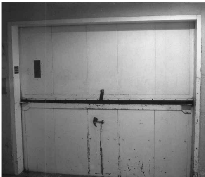
Figura 8.42 Una puerta cortafuegos contrabalanceada.
