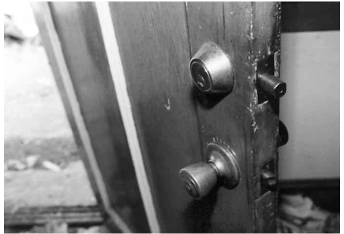
Figura 17.6 Compruebe si existen signos de entrada forzada realizados antes de la llegada del cuerpo de bomberos.
