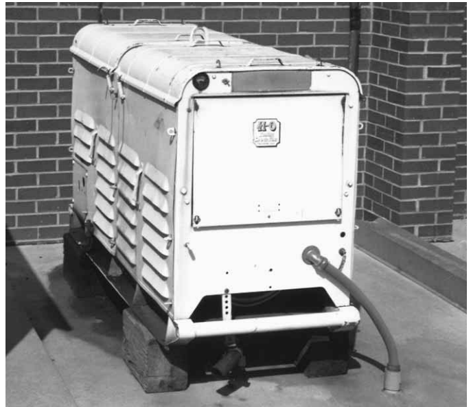
Figura 14.36 Muchas instalaciones tienen generadores eléctricos auxiliares que se activan cuando el suministro principal de energía se interrumpe.
