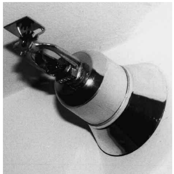
Figura 15.39 Rociador lateral instalado.
