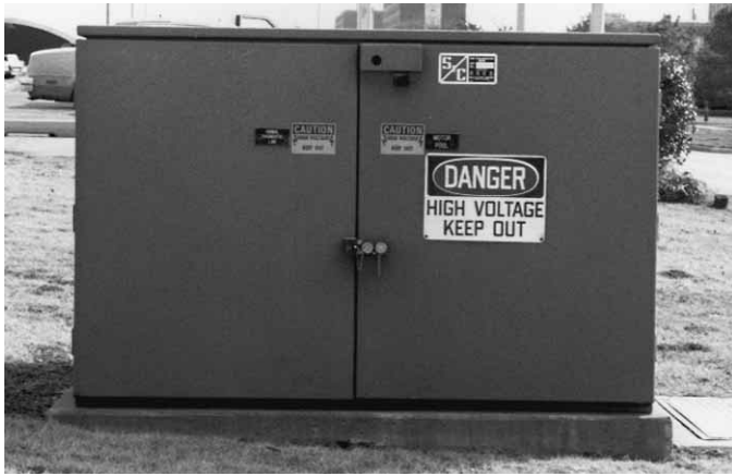
Figura 14.37 El equipo de alto voltaje es muy peligroso para los bomberos.
