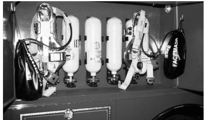
Figura 4.67 Instalación montada en un compartimiento.
