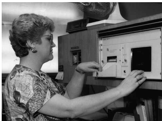
Figura 15.29 Los sistemas modernos proporcionan una copia impresa para indicar una avería del sistema.
