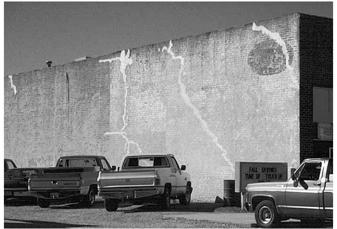
Figura 3.22 Los bomberos deben buscar grietas y fisuras reparadas en los muros de los edificios que puedan afectar a su integridad estructural.
