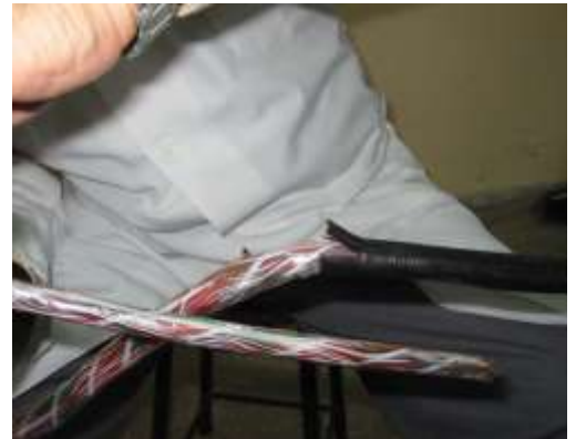
Kablonun ekran devamlılığı için 10 mm eninde 20mm boyunda AP kılıfın ayarlanan kılıf açma bıçağı ile açılması
