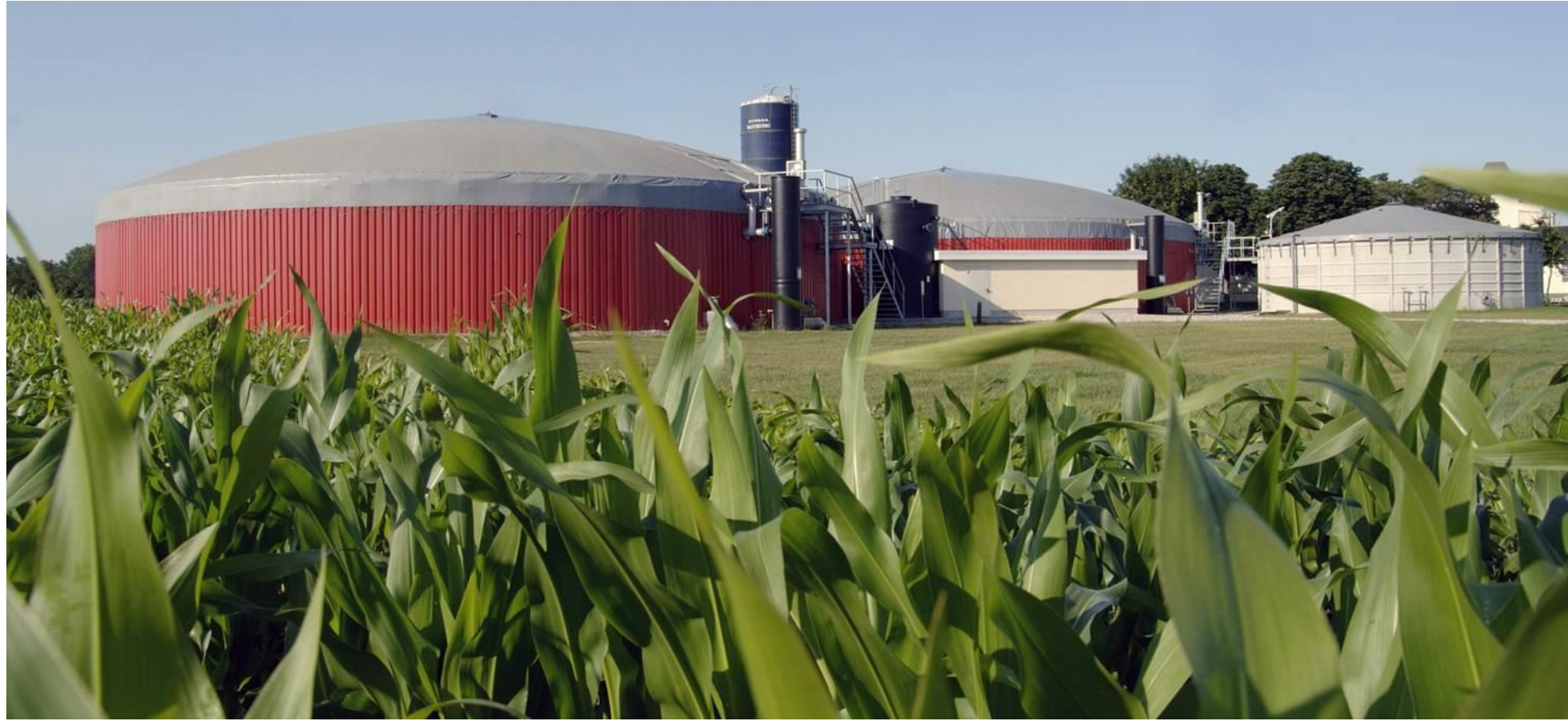
Bio Kütölə Elektrik enerji İstansiyası
