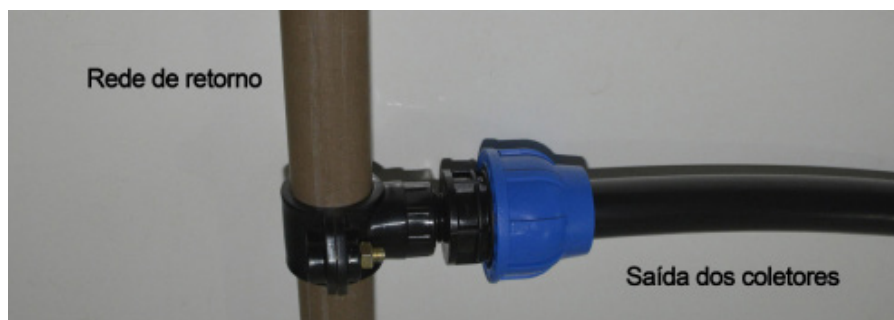
Figura 8: Adaptador unindo saída dos coletores à rede de retorno
