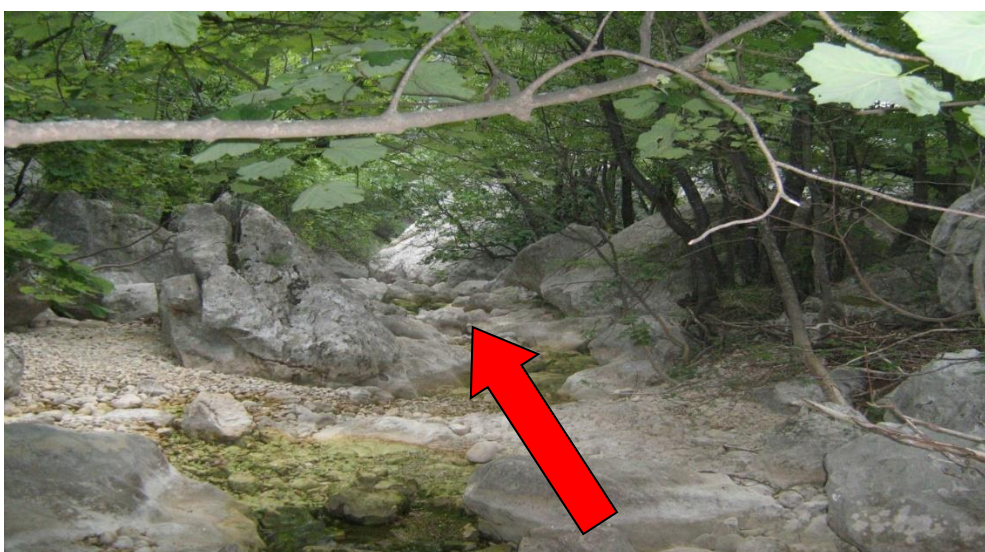
Slika 71. Ostanci otvora za čep retencije na Anića luci, koji je služio za ispuštanje akumulirane vode i prikupljenih trupaca prema Podgorskom kanalu. Snimljeno 2017. godine.
