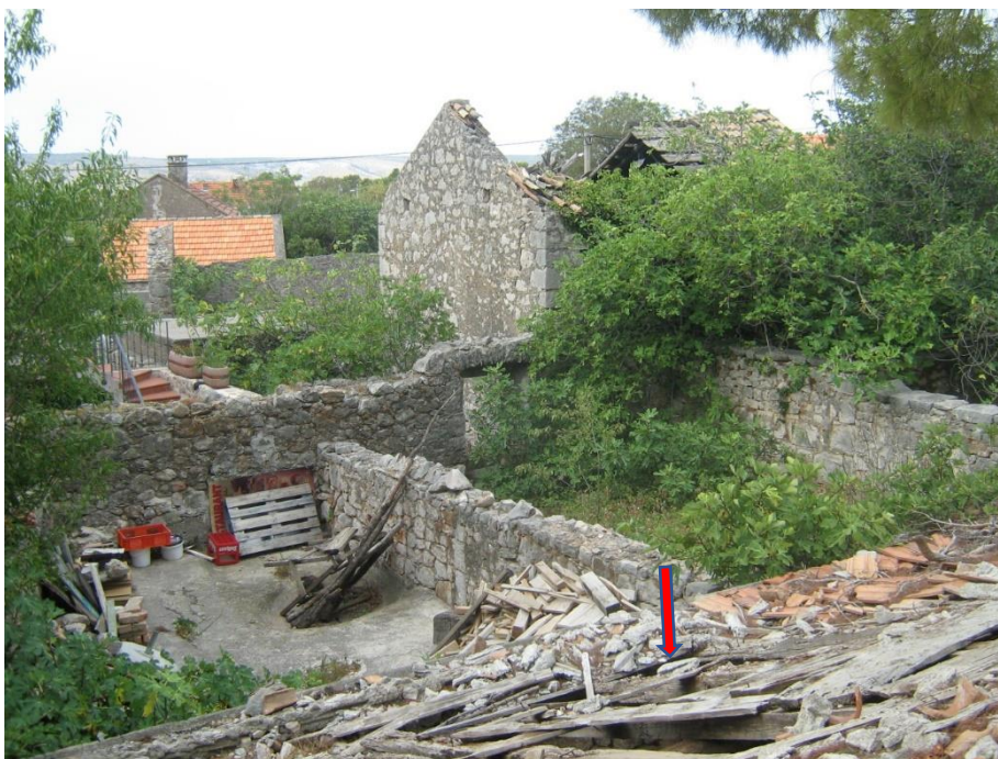
Slika 55. Ruševan krov nadstrešnice i otvoreni prostori ispred nje.
