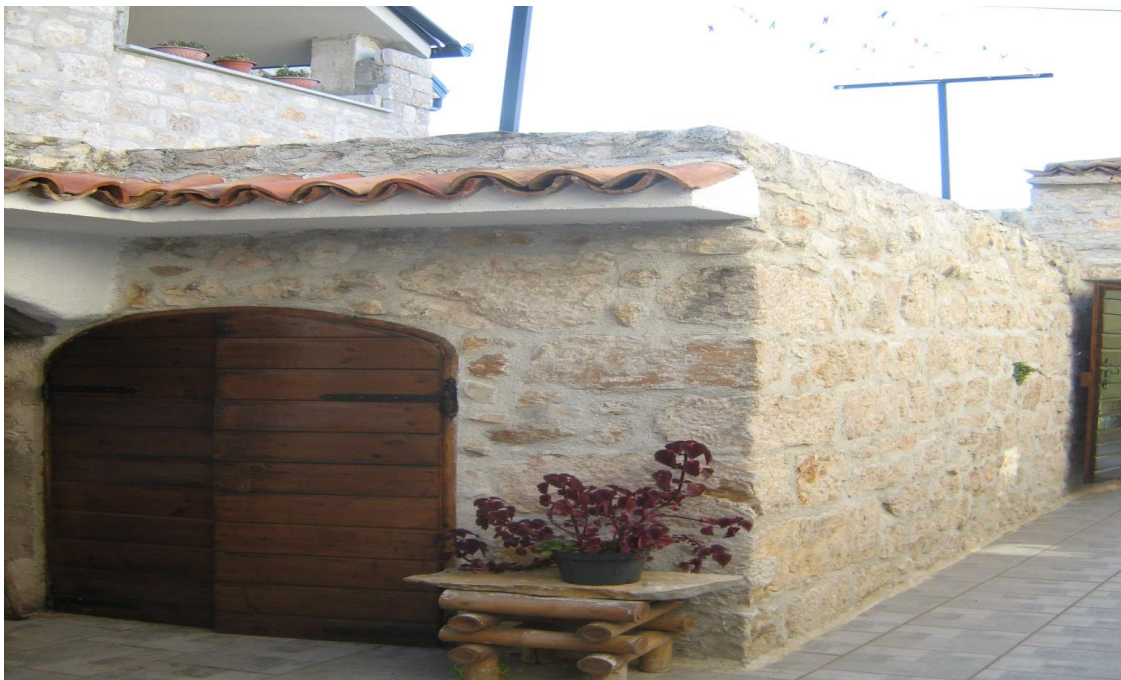
Slika 18. Probijeni otvor na sjevernom zidu gusterne.
