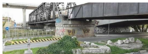
Fig. 2 Le fondazioni del Ponte Romano nel degrado
