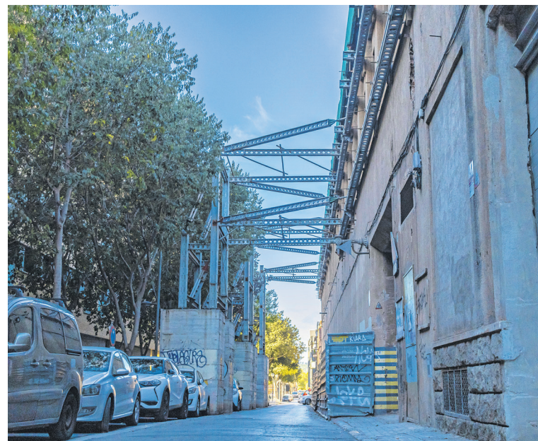
Detall de les parts metàl·liques dels estabilitzadors de la façana de la fàbrica Bosser, antic vapor Ca l'Escardat / AINA TORRES
