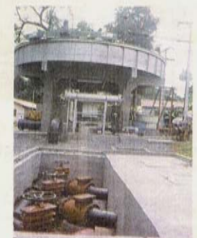
Vista de la Sala de Bombas, desde donde se envían los residuos a la parte superior de la Planta para el inicio del "Proceso de Tratamiento"
