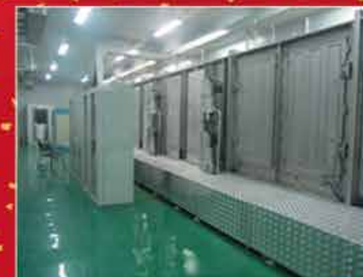
玻璃鍍膜連續生產線 Glass coating production line
