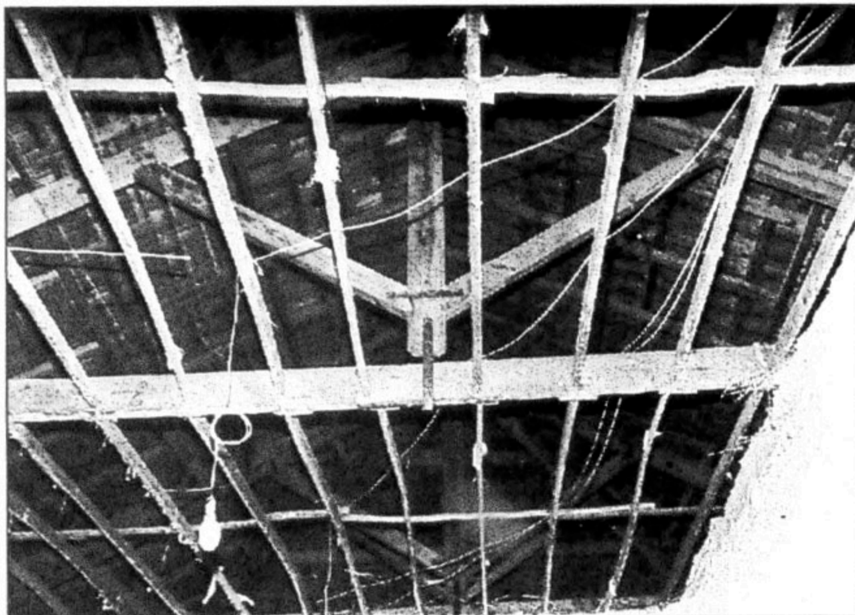
Aspecto que presentaba la estructura de madera del tejado después de caerse el techo el pasado diciembre.
