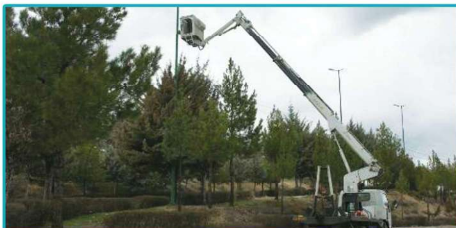
نورپردازی مسیر ورودی خط تله سیژ تپه شهدا از طریق نصب پرژکتورهای نوری
