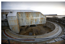
Slik så kanonen ut i 2016. Den var da i ferd med å skifte farge fra grått til rustbrunt, og var begynt å falle fra hverandre.
