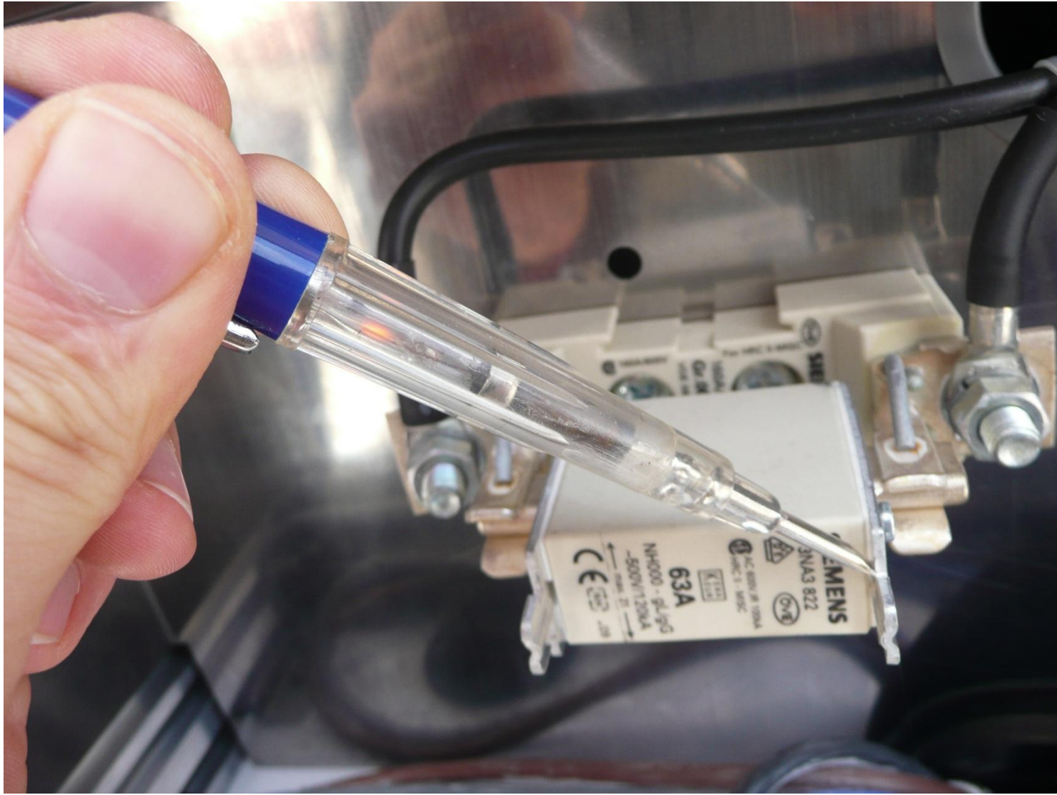
Kontrol Kalemi ile AC Kontrolü
