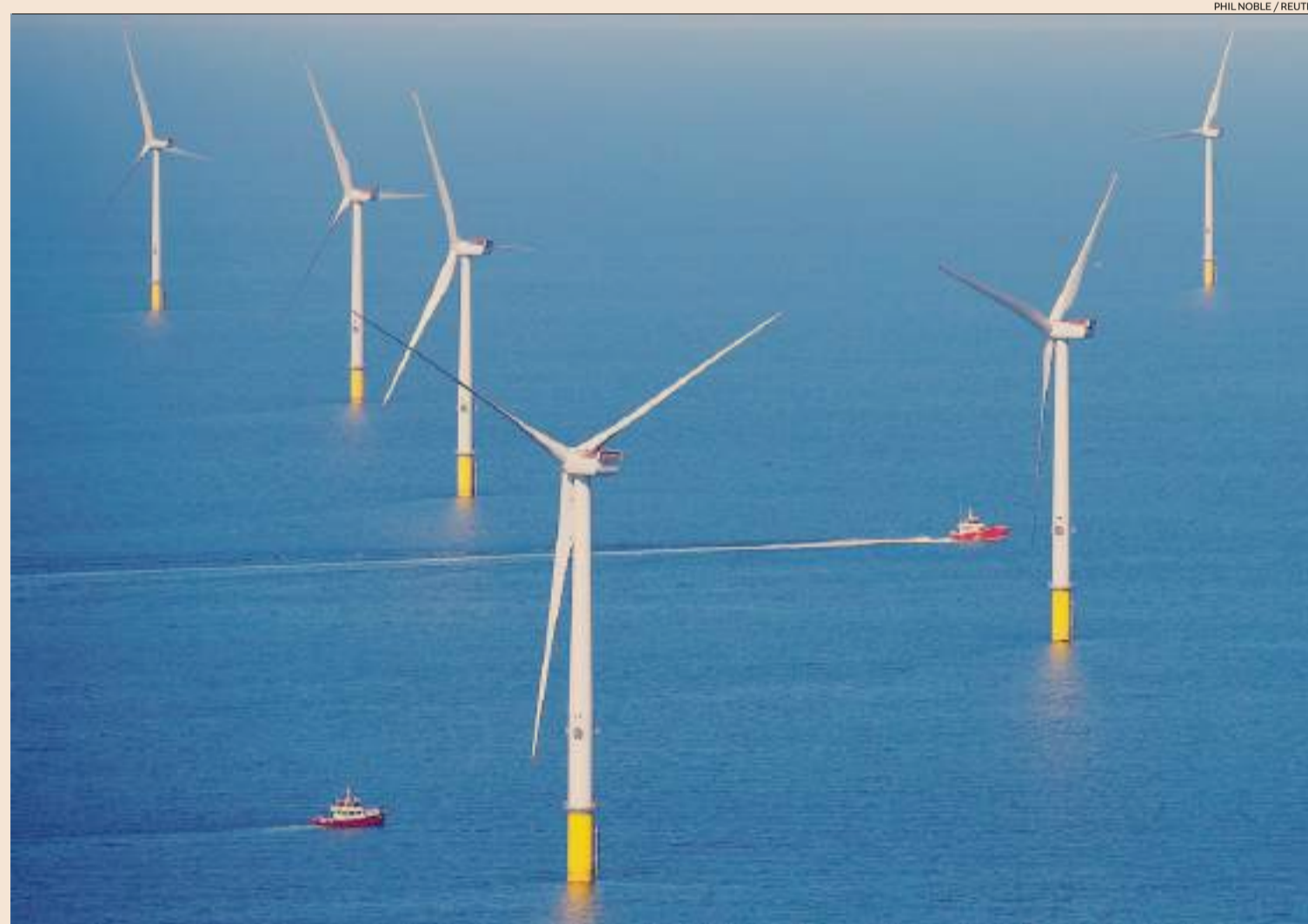
Vento e mare. La Burbo Bank Offshore Wind Farm, nella baia di Liverpool. Johnson ha promesso investimenti nell'energia eolica e nuovi posti di lavoro
