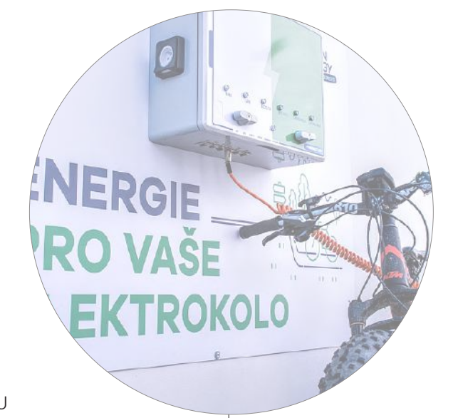
OSAZENÍ STANOVIŠŤ PRO DOBÍJENÍ ELEKTROKOL
