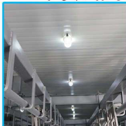
• برق کشی سالن پیش سردخانه
