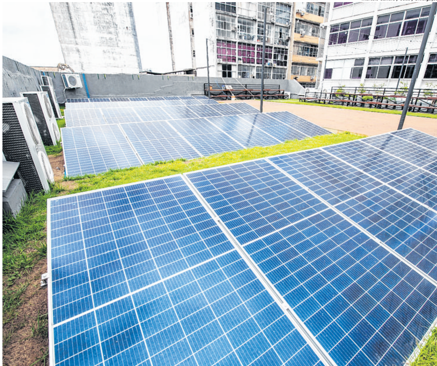
Placas para geração de energia solar na sede da Secretaria Municipal de Sustentabilidade, Inovação e Resiliência, no Comércio
