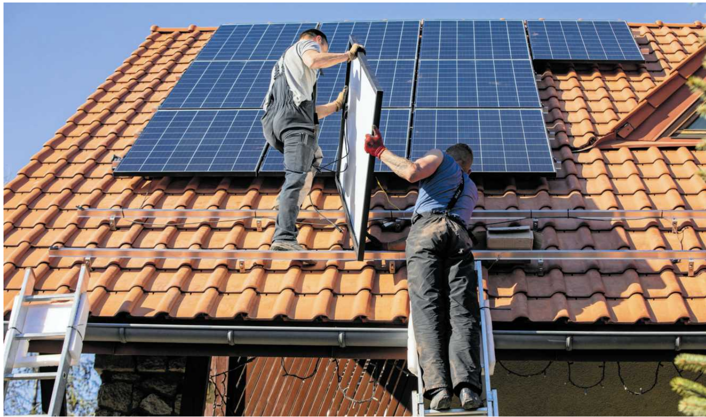
• Dla wielu osób własna instalacja fotowoltaiczna to sposób na obniżenie wysokości rachunków za prąd i ogrzewanie FOT. SHUTTERSTOCK
