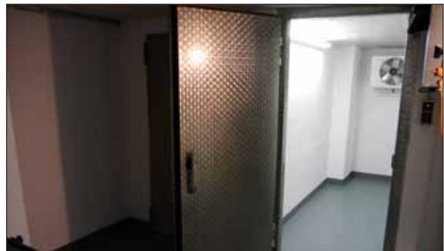
Kühlraum in der großen Halle
