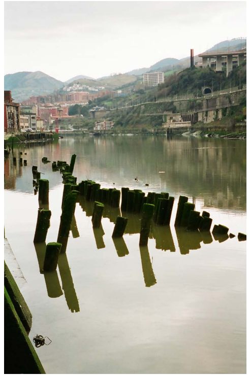
[11] a collapsed wooden landing-stage / un embarcadero de madera / egurrezko ontzira- lekua
