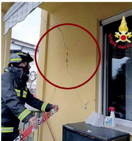
UMBERTIDE Una delle abitazioni lesionate al controllo dei vigili del fuoco
