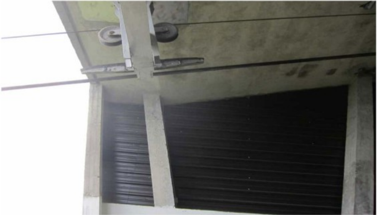
Abbildung 11: Entgleistes Tragseil Nr. 3 und auf den Rollen liegendes Bergeseil (Quelle: Digifema)
