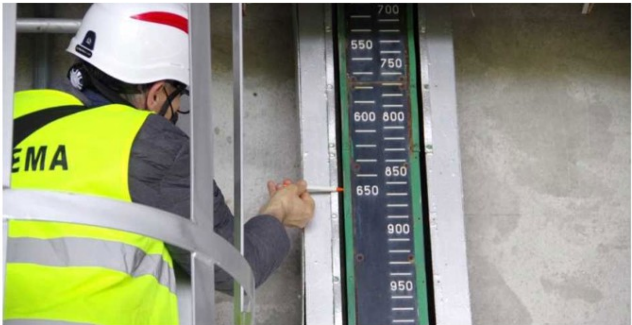
Abbildung 13: Detailaufnahme der Messkala. Die Position ist bei einem Spannweg von 6,50m limitiert. Es sind Scheuerstellen zwischen 5,50m und 6,00m zu sehen. (Quelle: Digifema)
