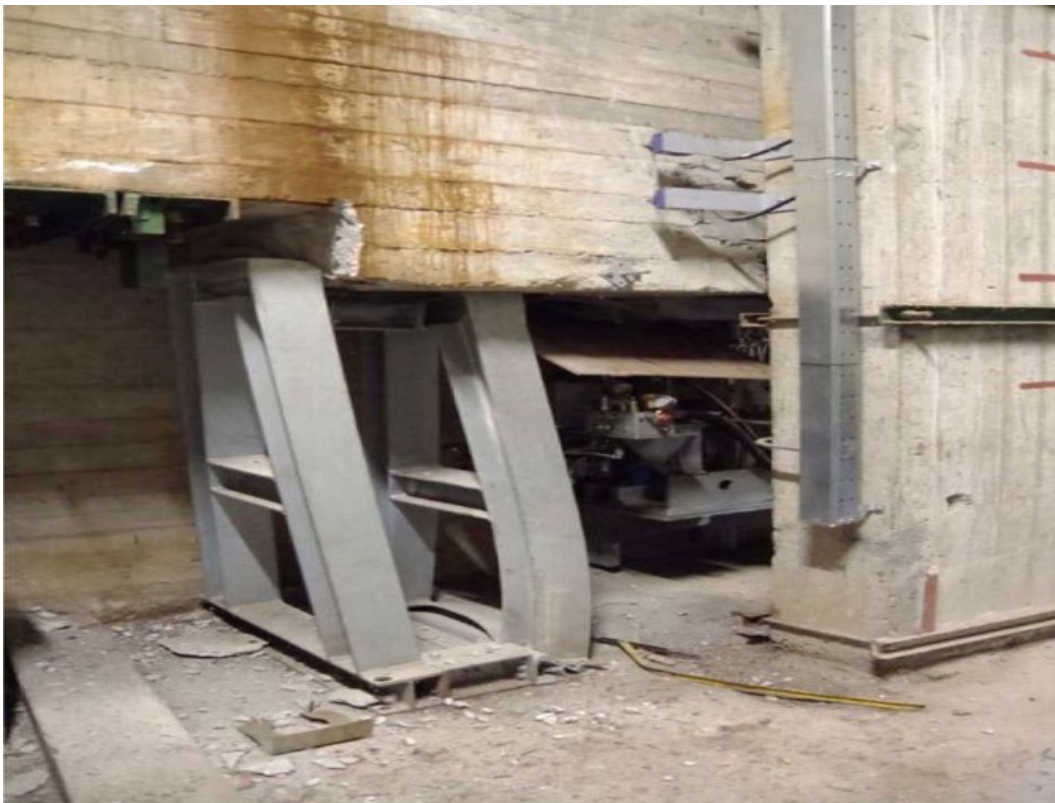
Abbildung 15: Spanngewicht des oberen Zugseiles ist auf der (deformierten) Unterkonstruktion aufgesessen (Quelle: Digifema)
