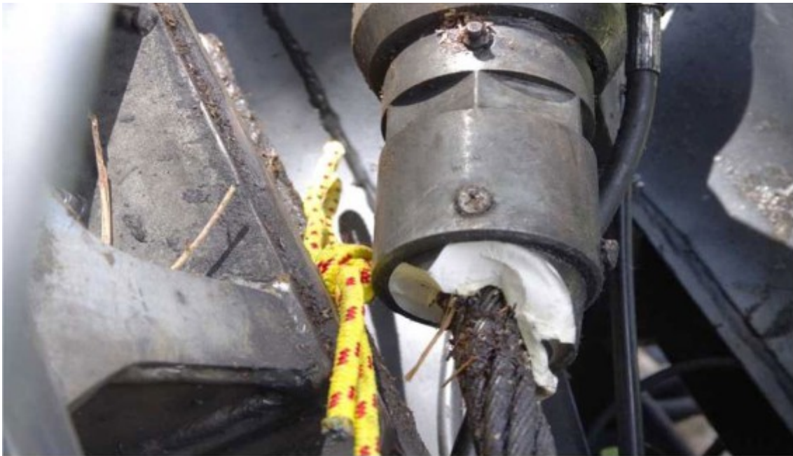
Abbildung 9: Vergusskopf des unteren Zugseiles - Ausgeführt am 14.03.2017 - Zur Ablage vorgesehen am 14.03.2022 (Quelle: Digifema)
