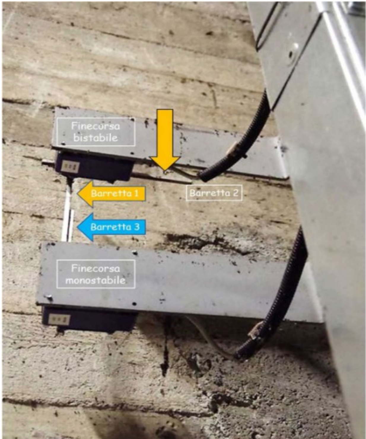
Abbildung 18: Vorgefundene Position des Alarmendschalters (Gelbe Pfeile) bzw. Not-Halt-Endschalters (Blauer Pfeil) - Eine Auslösung ist in dieser Position unmöglich
