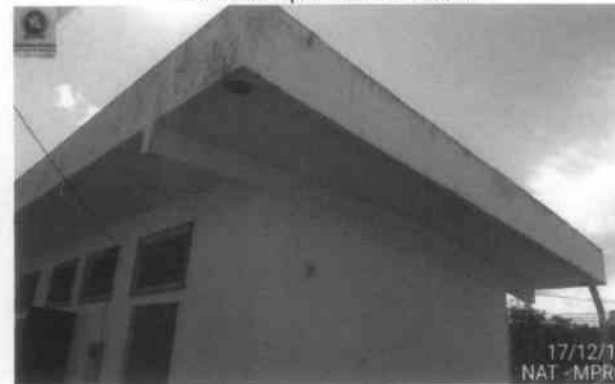
Foto 56: Casa de máquinas – não há tubulação para condução das águas pluviais.
