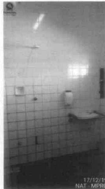
Foto 46: Bloco administrativo – comissariado e identificação com diversas peças quebradas.
