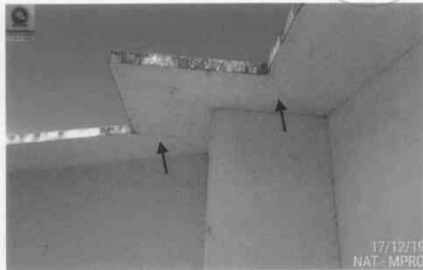
Foto 8: Pavilhão B – trinca na laje de beiral externa.
