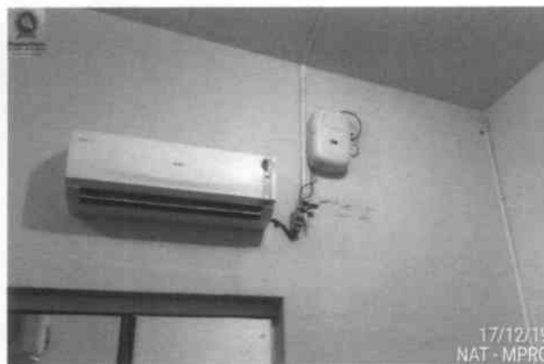
Foto 70: Bloco administrativo – fios e disjuntor expostos, central da cerca elétrica sem funcionamento.
