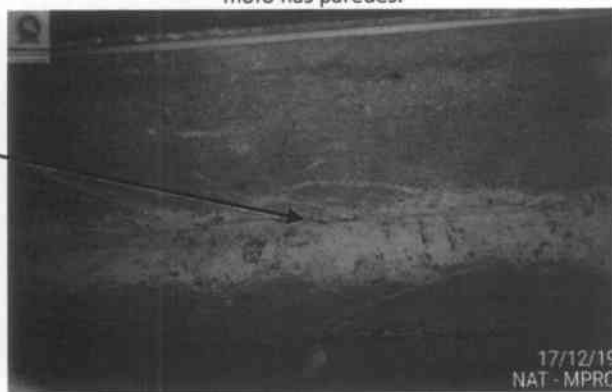
Foto 18: Detalhe da foto 17 – retirada da barra de aço, concreto esfarelando, sem resistência a abrasão.
