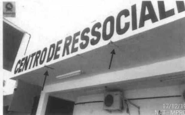
Foto 10: Bloco administrativo – segregação do concreto e oxidação da armadura devido à umidade.
