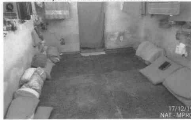
Foto 12: Bloco Enfermaria – Cella 02 com presença de umidade por toda a parede.
