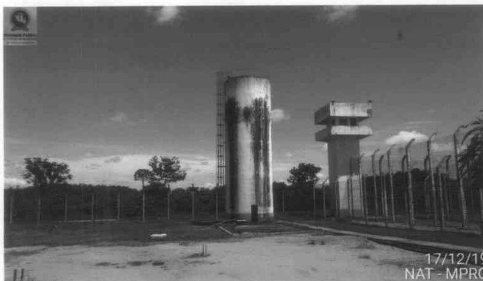
Foto 66: Reservatório elevado – diversos pontos de vazamento de água, com leve inclinação para esquerda.
