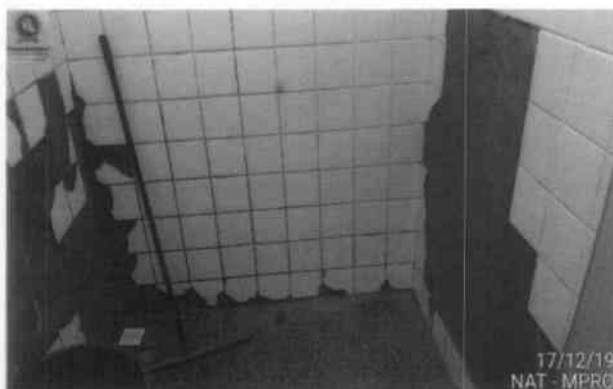
Foto 47: Pavilhão enfermaria – banheiro da cela com revestimento totalmente degradado e descolado da parede.
