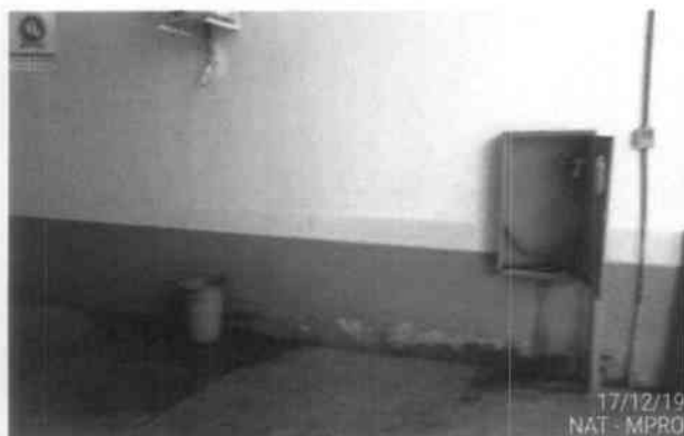
Foto 77: Pátio coberto – caixa de hidrante sem presença de mangueiras.
