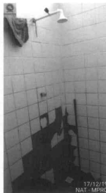
Foto 48: Pavilhão enfermaria – banheiro da cela com peças degradadas e descolamento da superfície.
