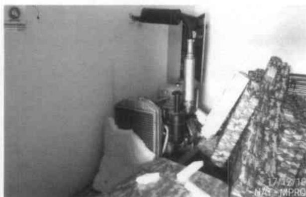
Foto 67: Gerador de energia a diesel – não está apto ao funcionamento, não realizaram a instalação completa.
