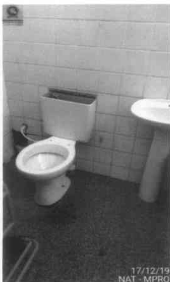
Foto 57: Pavilhão enfermagem – bacia sanitária e lavatório sem torneira, sem fornecimento de água neste banheiro.
