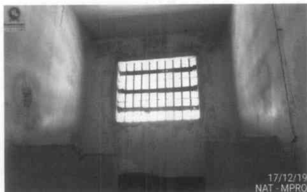
Foto 22: Pavilhão inclusão – reposição da grade após tentativa de fuga.
