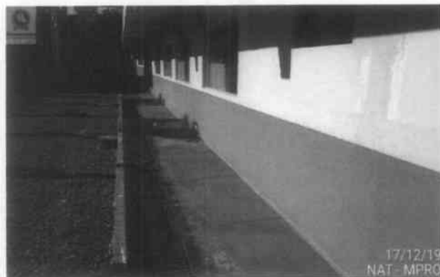
Foto 11: Bloco administrativo – umidade no rodapé das paredes causada pela água proveniente dos condicionadores de ar.
