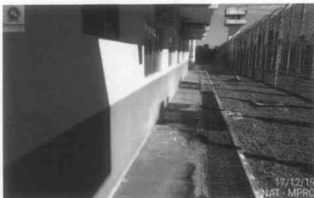
Foto 49: Bloco administrativo – umidade pontual constante nas paredes e calçadas, sem drenos dos condicionadores de ar.
