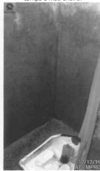
Foto 62: Pavilhão vivência – garrafa pet na latrina, tentativa de bloquear o mau cheiro.
