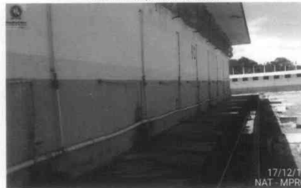
Foto 54: Pavilhão B – rede hidráulica aparente com vazamentos por toda extensão.
