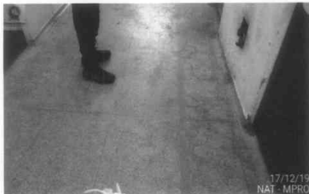
Foto 31: Pavilhão vivência – piso granilite com manchas de umidade e trincas por toda superfície.
