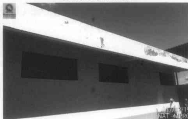
Foto 43: Pavilhão enfermaria – platibandas com umidade generalizada, pintura degradada.
