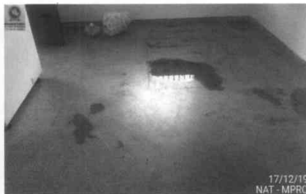
Foto 30: Pavilhão Enfermagem – acúmulo de água no piso.
