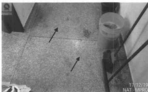
Foto 27: Bloco administrativo – circulação com trincas no piso granilite.
