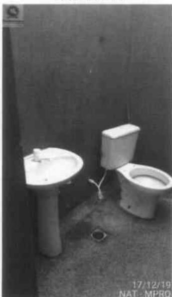
Foto 60: Pavilhão enfermagem – ralo sem tampa.
