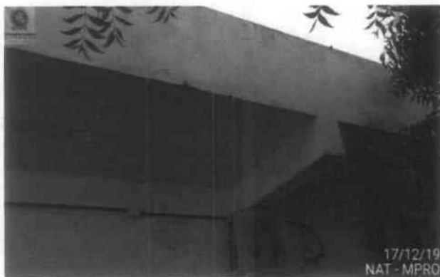
Foto 40: Bloco administrativo – platibanda com infiltrações generalizadas na parede e laje.
