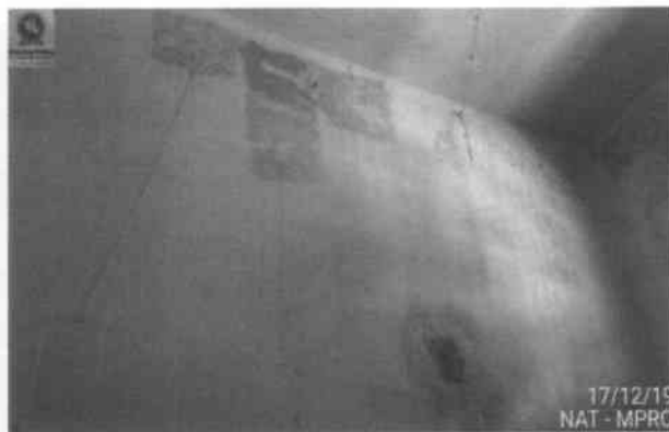
Foto 16: Pavilhão vivência – excesso de umidade, presença de mofo nas paredes.
