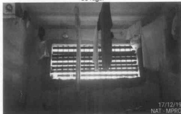
Foto 24: Pavilhão B – janela retirada pelos presos sem utilização de ferramentas, apenas forçando a retirada.
