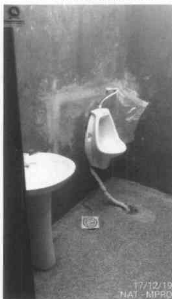
Foto 61: Pavilhão enfermagem – ligação de esgoto improvisada, mau cheiro.
