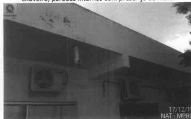
Foto 55: Bloco administrativo – sem rede adequada para direcionamento das águas pluviais.
