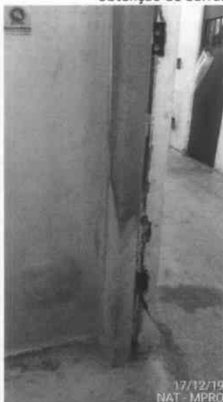
Foto 19: Pavilhão vivência – segregação do concreto no batente da porta.
