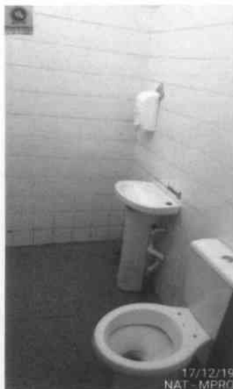
Foto 58: Pavilhão B – sanitário de uso dos agentes, lavatório sem torneira, e bacia sanitária danificada.
