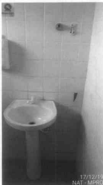
Foto 44: Bloco administrativo – banheiro com azulejo quebrado.
