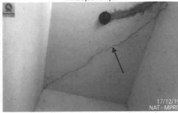
Foto 6: Pavilhão B – rachadura e infiltração em todas as dependências e celas do bloco.
