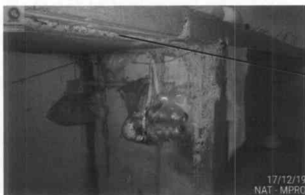
Foto 17: Pavilhão B – segregação ocasionada por detentos para obtenção de barras de aço.
