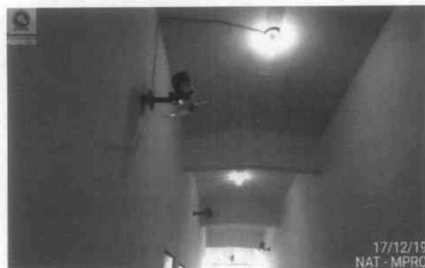
Foto 73: Sala de visitas – extensões precárias, fios expostos.
