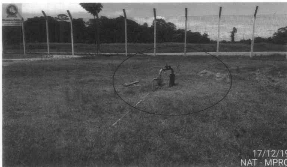
Foto 65: Captação da água do poço – detalhe do vazamento do cavalete.
