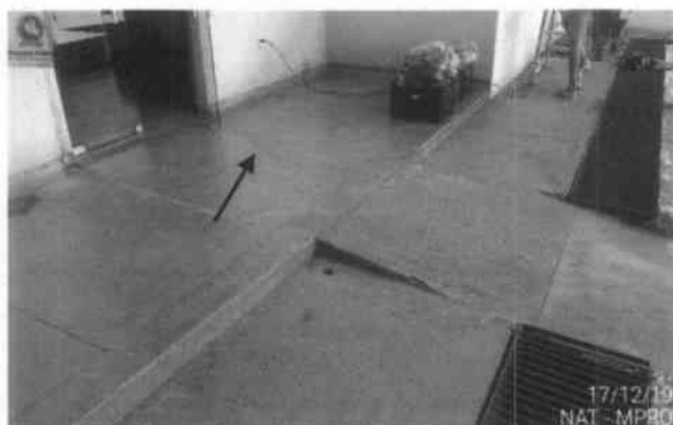
Foto 29: Bloco administrativo – rachadura no hall de entrada.
