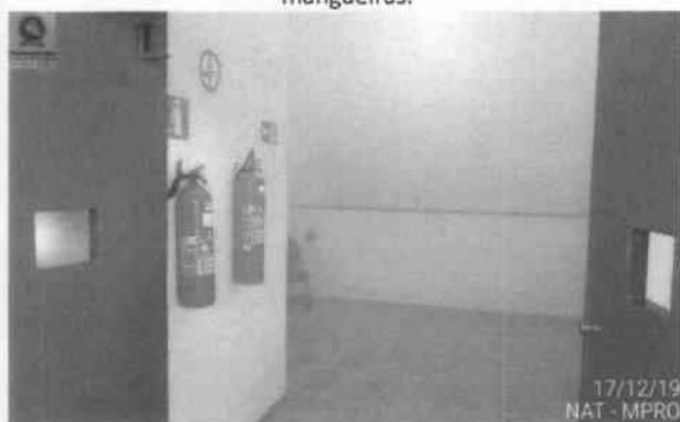
Foto 79: Pavilhão enfermagem – diversos extintores com carga vencida.
