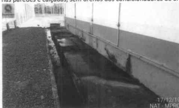
Foto 51: Pavilhão inclusão – rede hidráulica aparente com diversos vazamentos em toda extensão.
