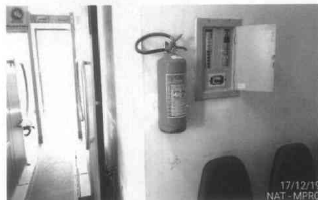
Foto 75: Bloco administrativo – quadro de distribuição com disjuntores, não há dispositivo DR.
