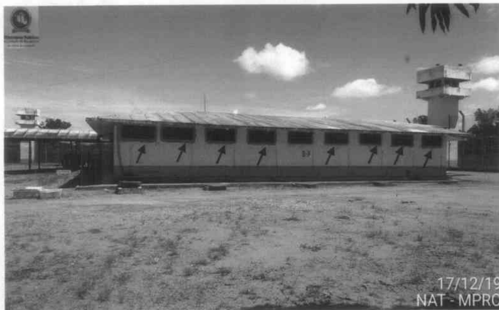
Foto 26: Pavilhão B – vista externa, as grades de todas as celas foram alvo de tentativa de retirada.
