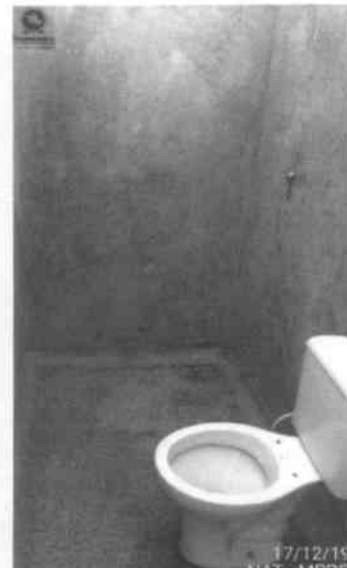
Foto 59: Pavilhão Enfermagem – sanitário para sala de visita, sem tampa e mau cheiro.
