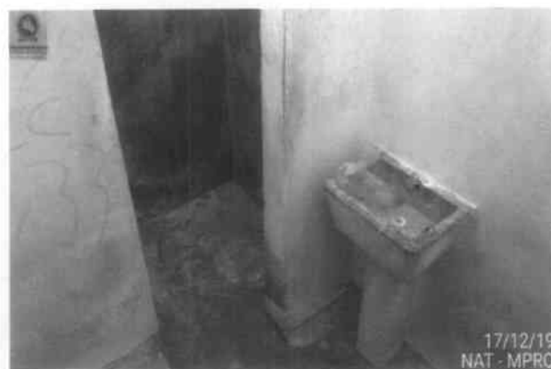
Foto 35: Pavilhão vivência – piso da cela danificado para escavação de túnel.
