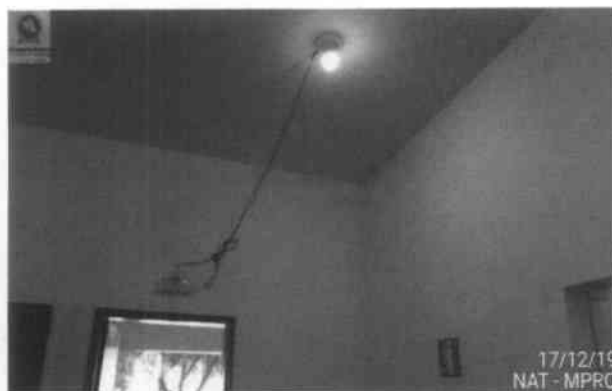
Foto 78: Bloco administrativo – luminária de emergência sem ligação na rede elétrica.
