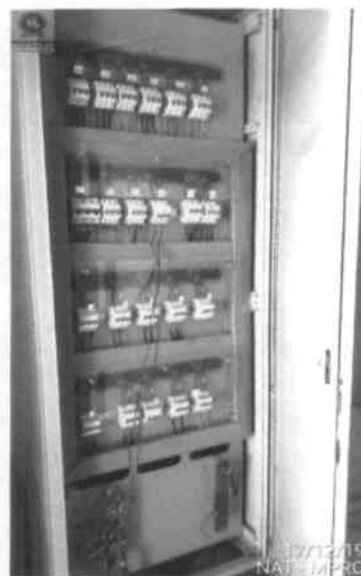
Foto 68: Quadro de distribuição geral – instalado na casa de máquinas, fios por cima da proteção em acrílico.
