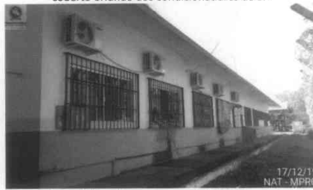
Foto 52: Pavilhão enfermagem – rede hidráulica aparente, vazamento por toda a rede.
