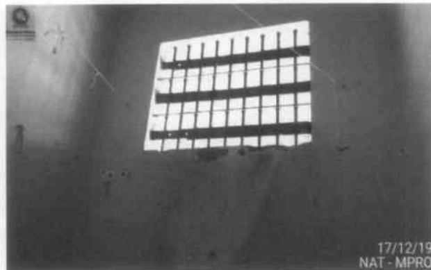
Foto 23: Pavilhão Inclusão – desagregação do concreto próximo a grade (janela), realizada pelos presos.
