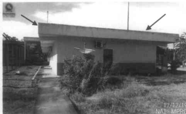
Foto 41: Bloco Administrativo – infiltrações generalizadas nas paredes da platibanda.
