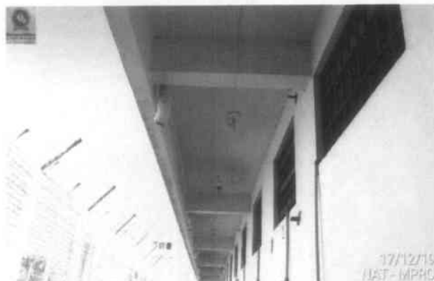
Foto 71: Pavilhão inclusão – rede elétrica exposta.
