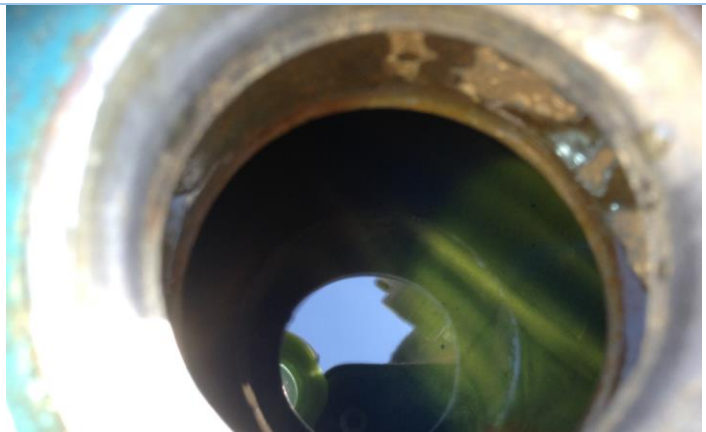
Een roestvrije tank. Deze tank is ook voorzien van epoxy coating aan de binnenkant (niet zichtbaar).
