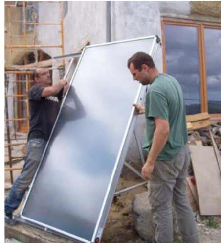
9/12: Solar thermal panel / Panel solar térmico
