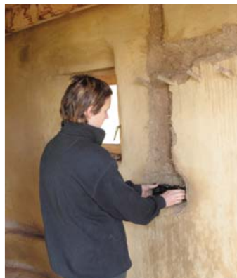
3/07: Electricity boxes / Cajas para el cableado
