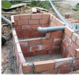
6/12: Composting chambers / Cámaras de compostaje
