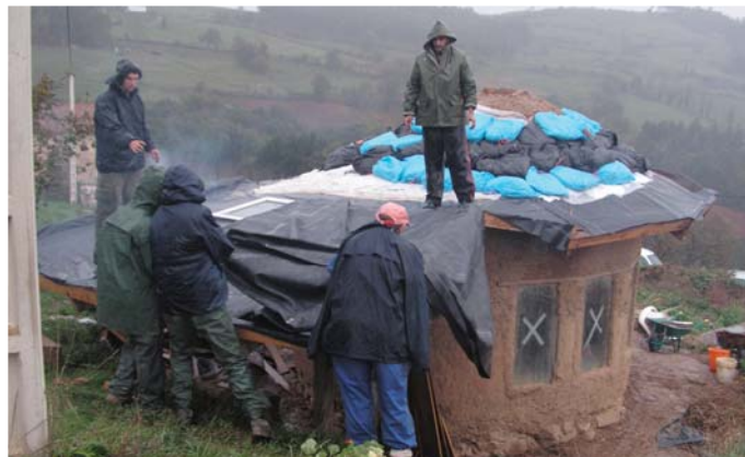
12/06: Roof membrane on at last / Poniendo membrana de caucho en el tejado, al fin
