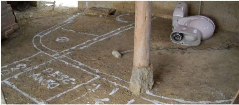
9/11: Layout for bathrooms and staircase / Plan para cuartos de baño y escaleras
