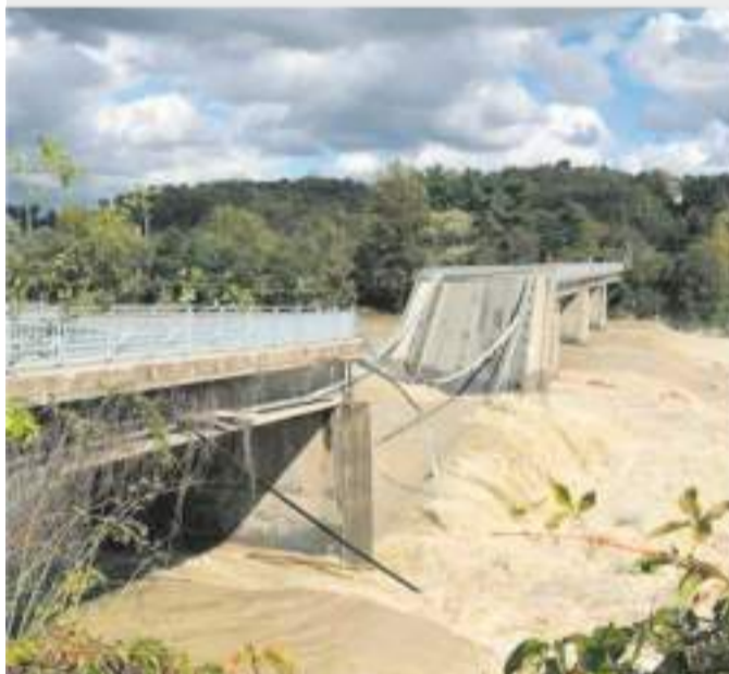
APOCALISSE Il ponte di Romagnano Sesia aperto e poi crollato
