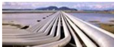
Υπόγεια Αποθήκη Φυσικού Αερίου Καβάλας
