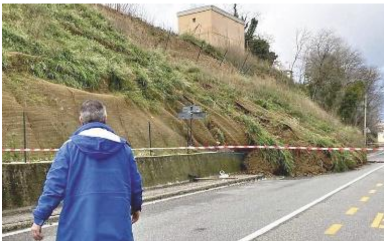
La zona dove si è verificato il cedimento
