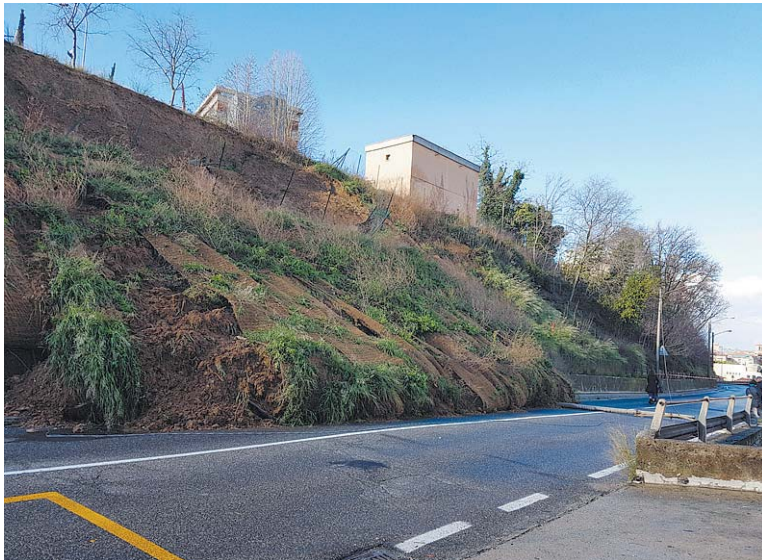
Scivolamento della terra Ieri pomeriggio l'ospedale ha organizzato subito un sopralluogo con la ditta che aveva svolto i lavori di consolidamento, presente un funzionario del Comune
