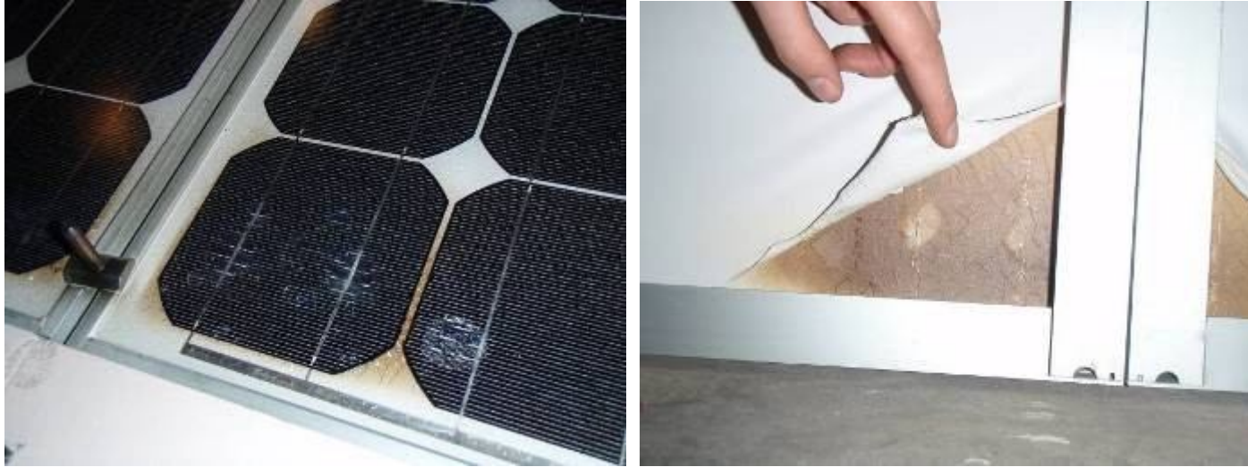
Isı etkisi nedeniyle modül hasarı
