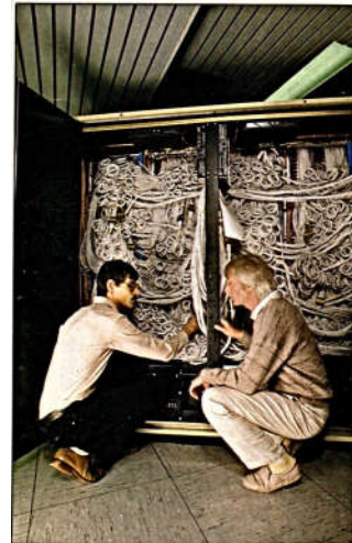
Als verwirrendes Dickicht von Kabeln präsentiert sich die Rückseite der Rechnerschränke. Die Länge der einzelnen Kabel ist genau vermessen, weil durch sie die Laufzeit der Signale bestimmt wird.
