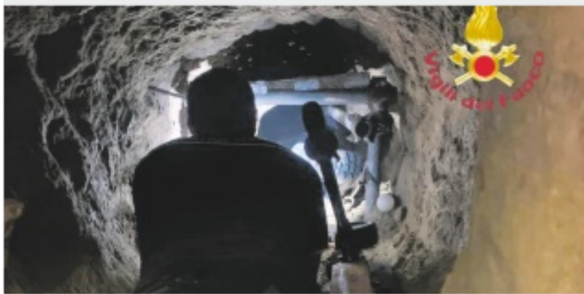
CROLLO Il cunicolo scavato dai banditi in via Innocenzo XI, vicino a San Pietro
