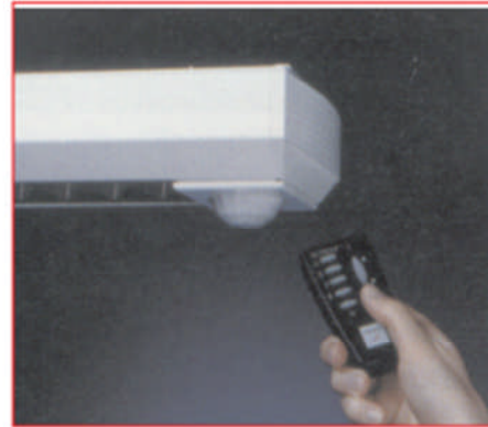
Régulation de l'éclairage artificiel par rapport à l'éclairage naturel (Trilux Belgium).
