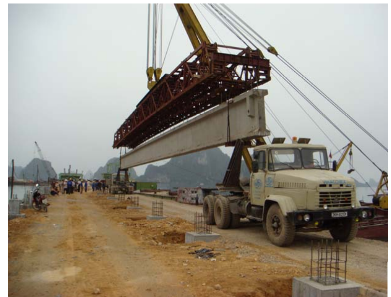
DÀM CẦU BĂNG TẢI NM XI MĂNG CẨM PHẢ/ CAM PHA CEMENT FACTORY
