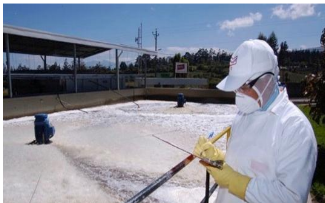
Planta de tratamiento de agua
