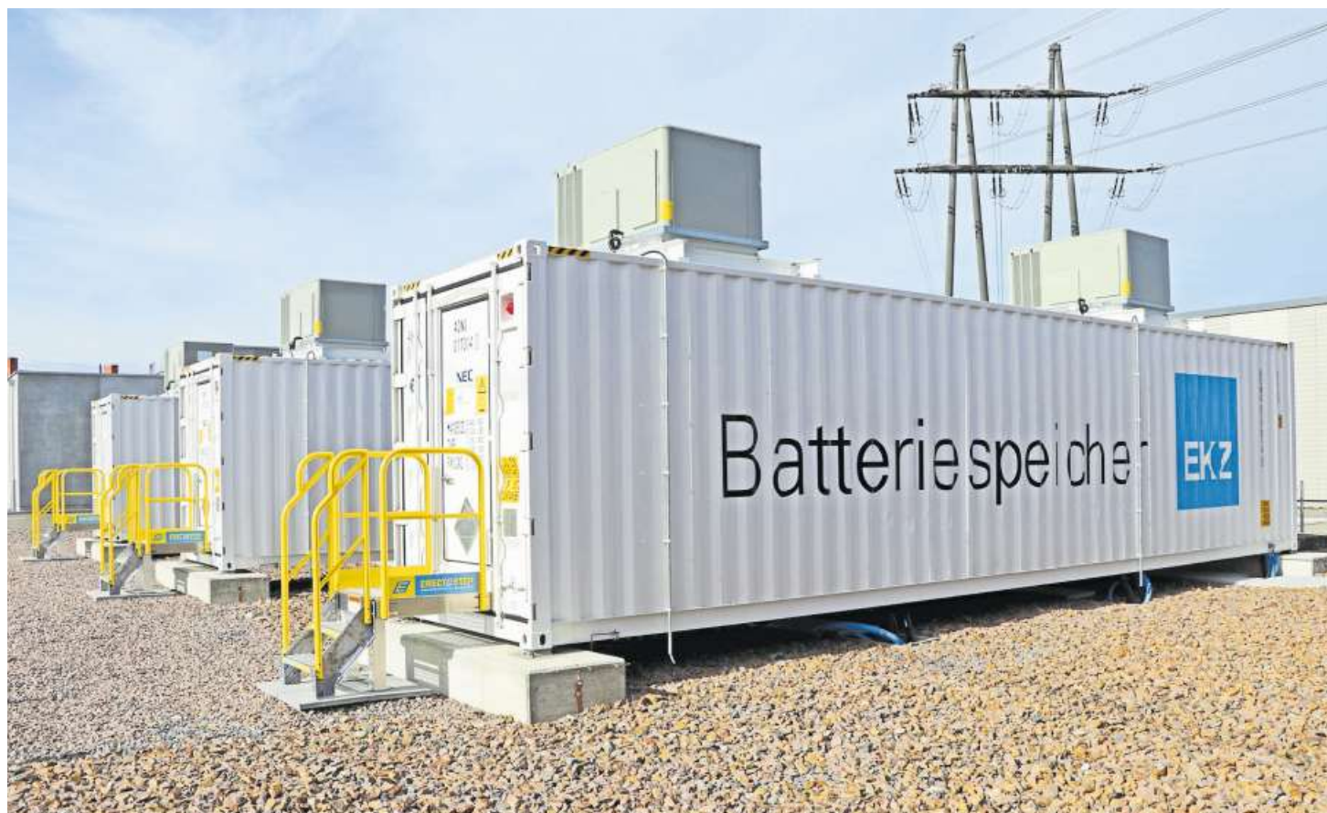
Der Gross-Batteriespeicher in Volketswil liefert 18 Megawatt Maximalleistung.
