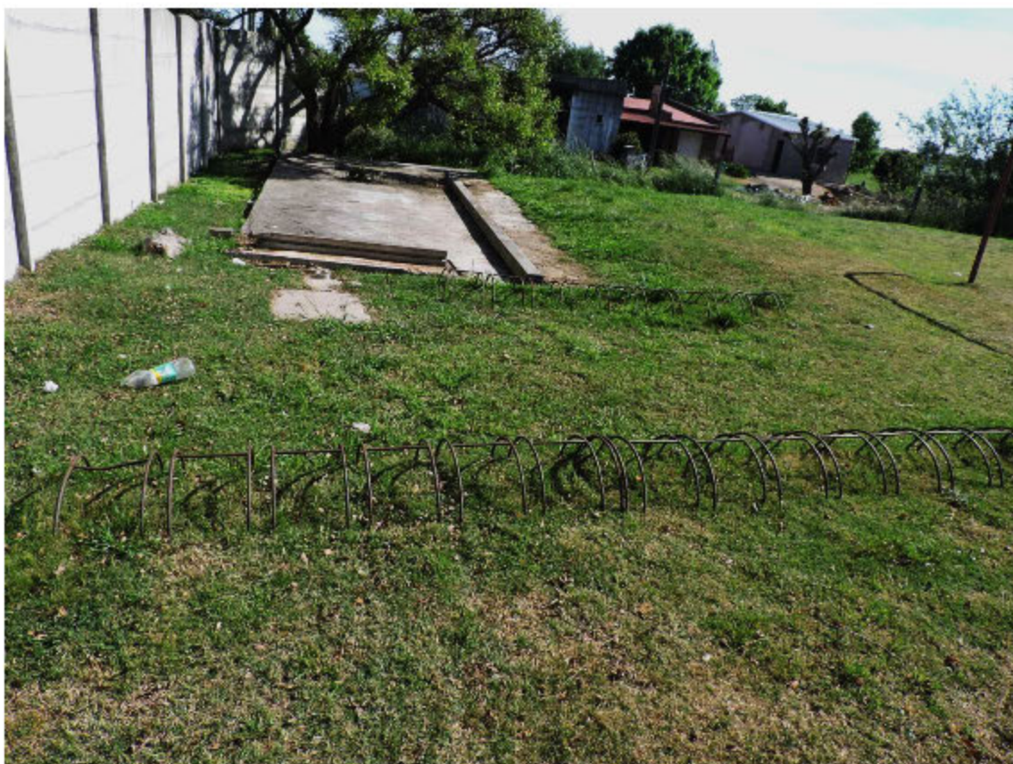
Cámara con aguas hervidas situada en un desnivel (se desborda cuando llueve)
