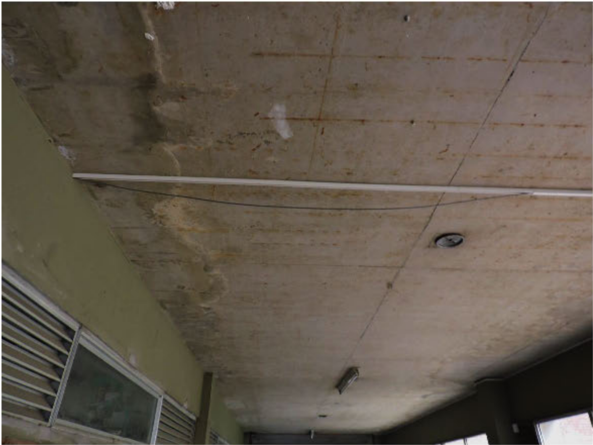
Tubos de luz sin protección mecánica
