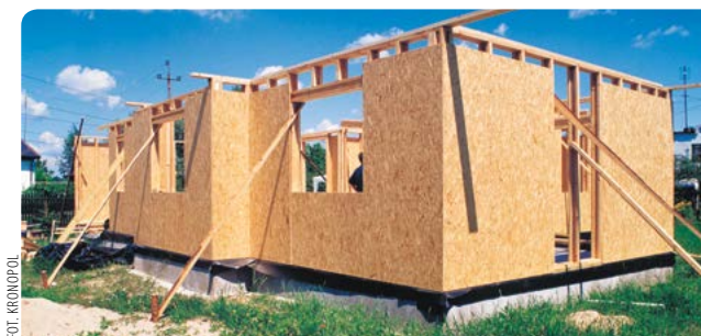
► Mały ciężar domu szkieletowego sprawia, że fundamenty mogą być mniej masywne, a co za tym idzie – tańsze
