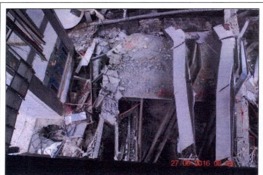
FOTO 20 – Trecho que desabou incluindo escadas rolantes
