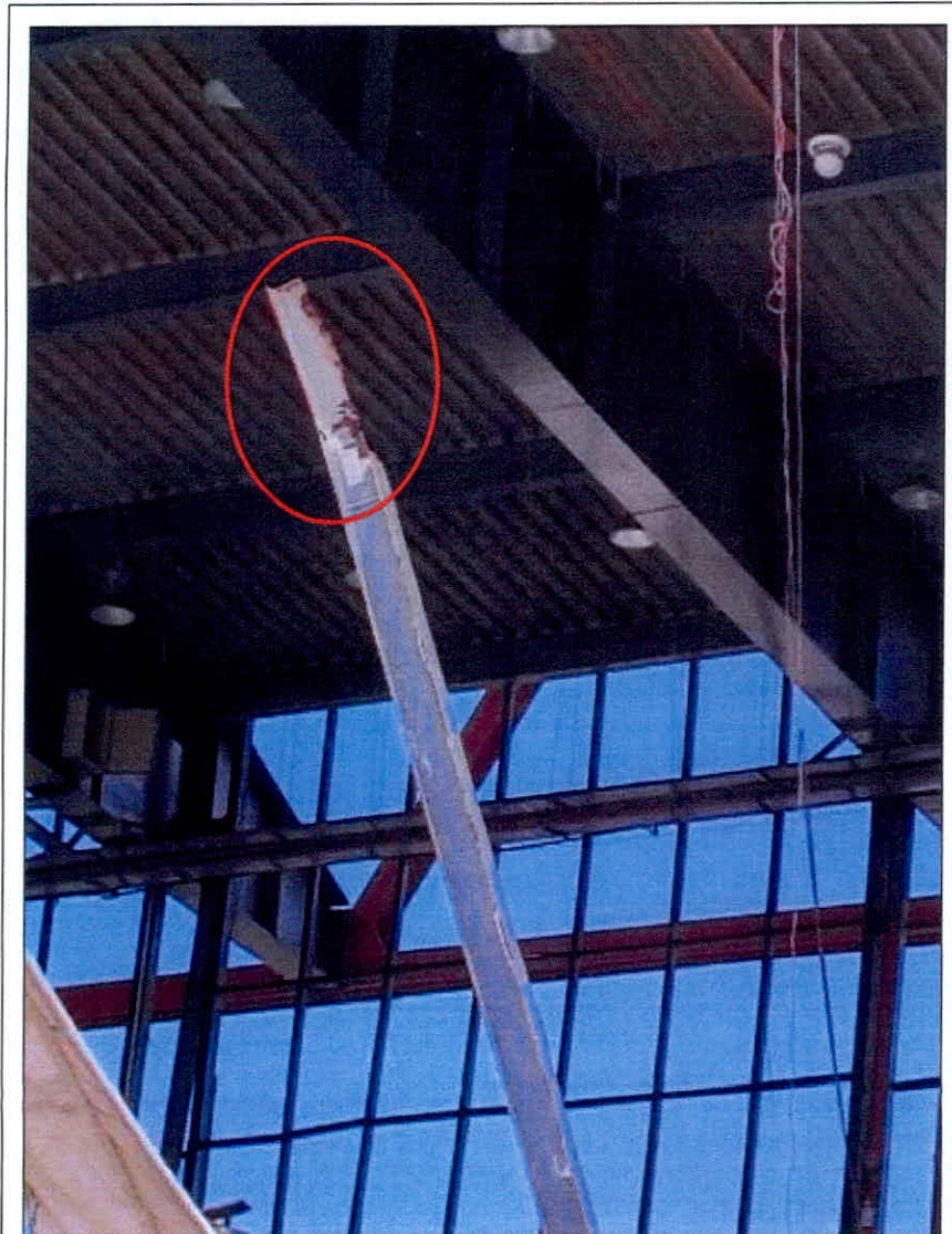
FOTO 34 – Tirante lado esquerdo da Viga 12
