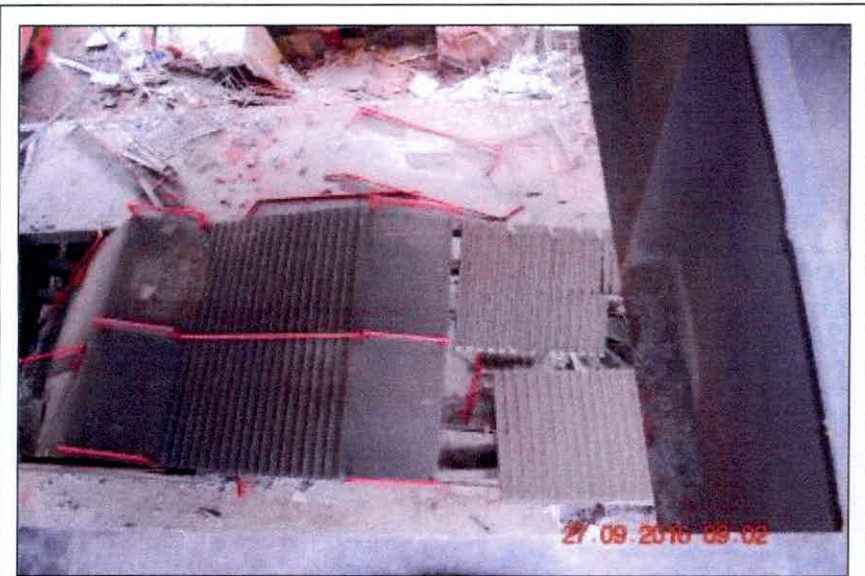
FOTO 28 – Trecho que desabou incluindo escada
