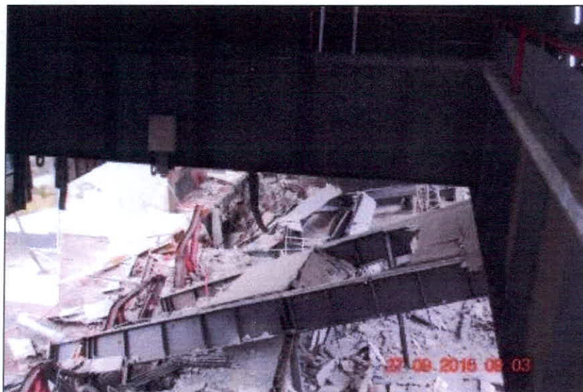
FOTO 29 – Viga 12 - local que os tirantes romperam (lado leste – Mar)
