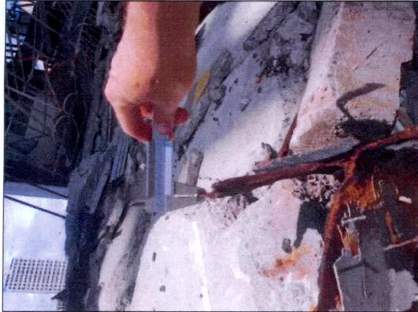
FOTO 37 – Espessura tirante direito 2,8mm
