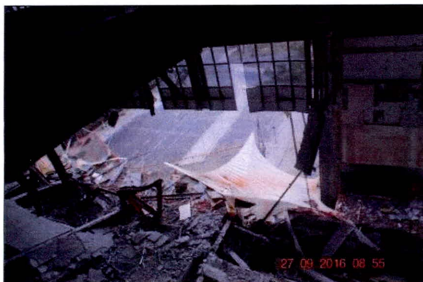
FOTO 24 – Trecho que desabou
