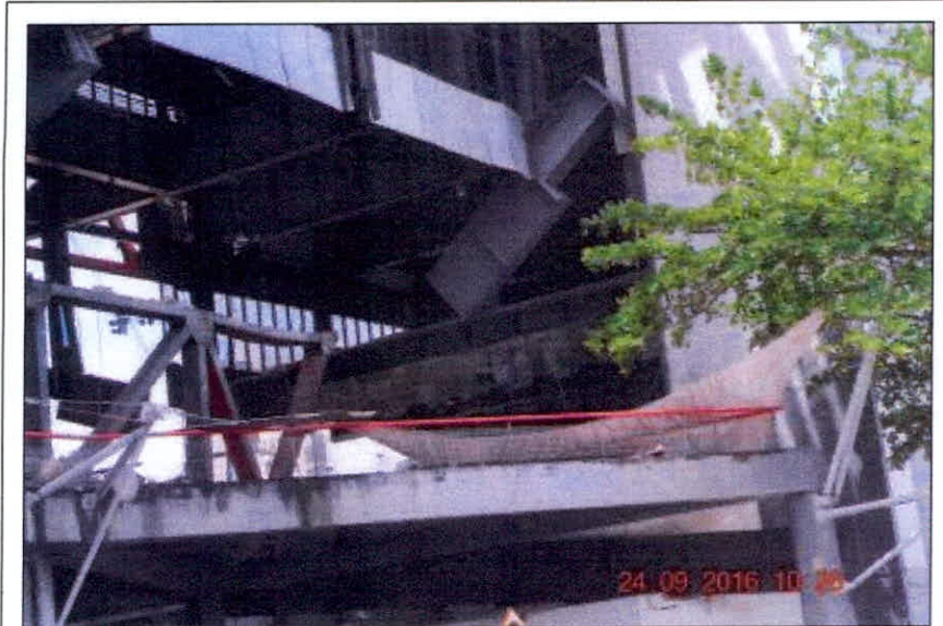
FOTO 11 – Desprendimento da fixação de um dos lados da viga (lado leste – MAR)
