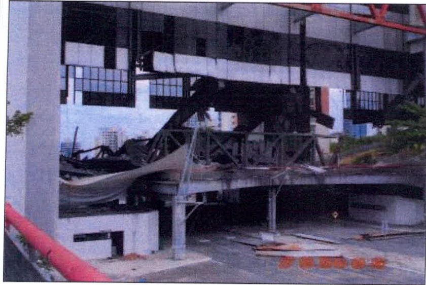
FOTO 15 – Local desabamento (vista leste)
