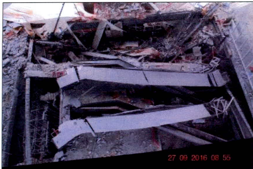
FOTO 25 – Trecho que desabou incluindo escadas rolantes
