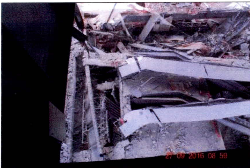
FOTO 26 – Trecho que desabou incluindo escadas rolantes
