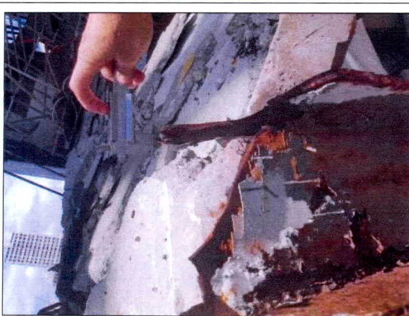
FOTO 38 – Espessura tirante direito 3mm
