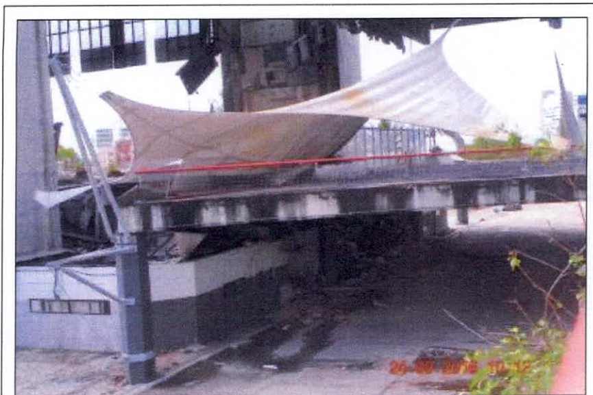
FOTO 07 – Local desabamento e danos no andar térreo
