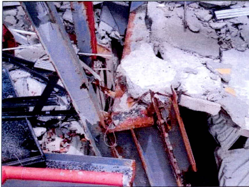
FOTO 35 – Tirante lado direito da Viga 12
