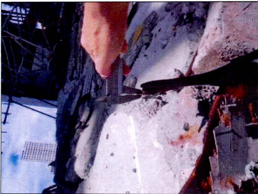
FOTO 36 – Espessura tirante direito 3mm
