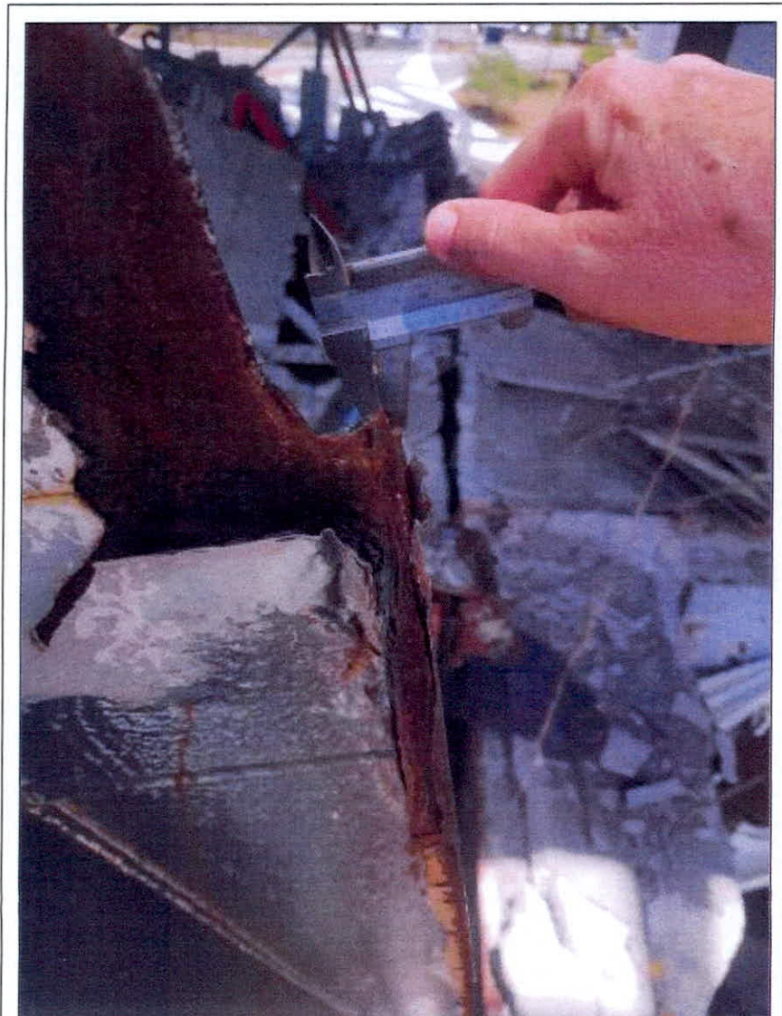
FOTO 41 – Espessura tirante esquerdo 1,8mm
