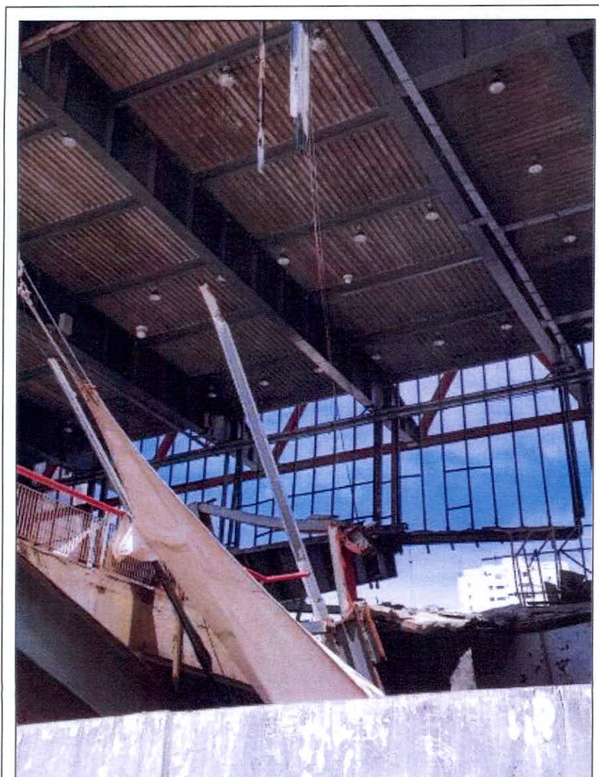
FOTO 32 – Tirantes da Viga 12 (rompeu primeiro o da direita e depois o da esquerda – lado leste – MAR)
