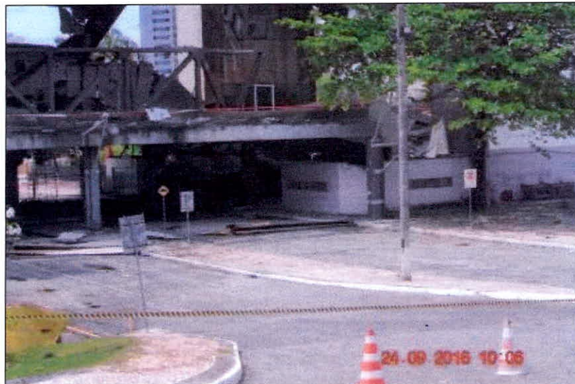
FOTO 04 – Local desabamento (lado oeste)
