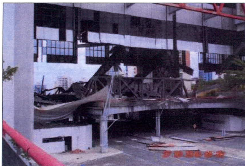
FOTO 30 – Vigas que perderam a sustentação do lado mar
