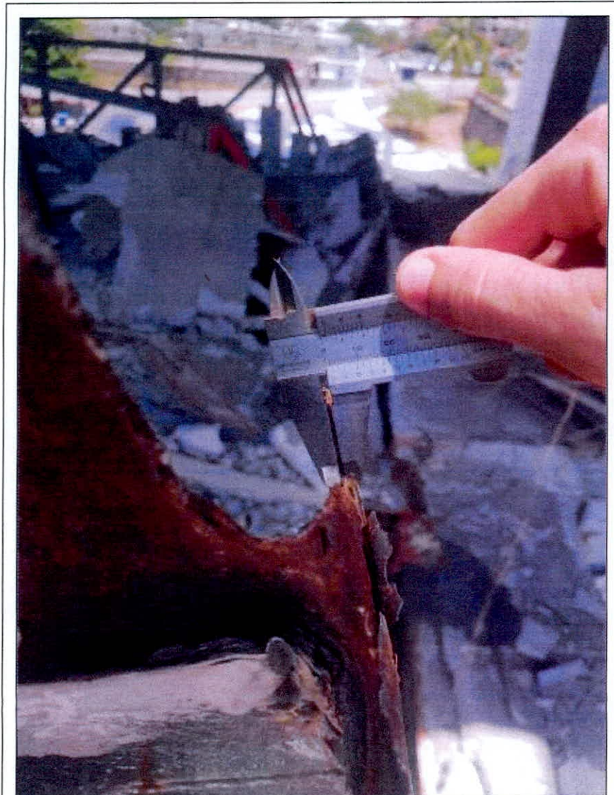
FOTO 42 – Espessura tirante esquerdo 1,8mm
