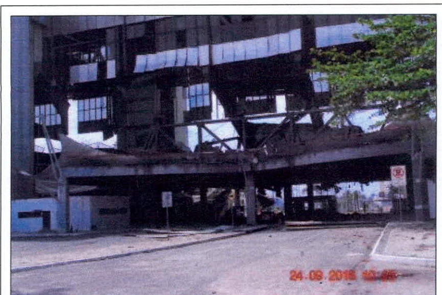
FOTO 08 – Vista oeste (local desabamento)
