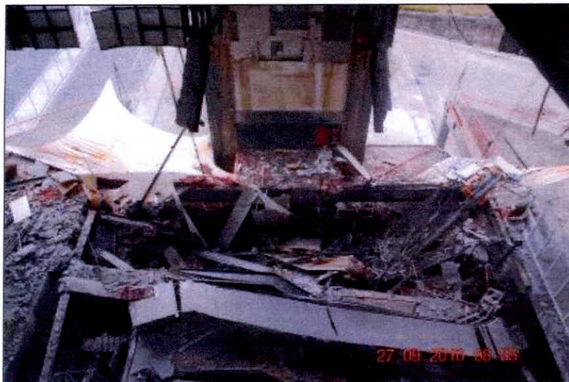
FOTO 23 – Trecho que desabou incluindo escadas rolantes
