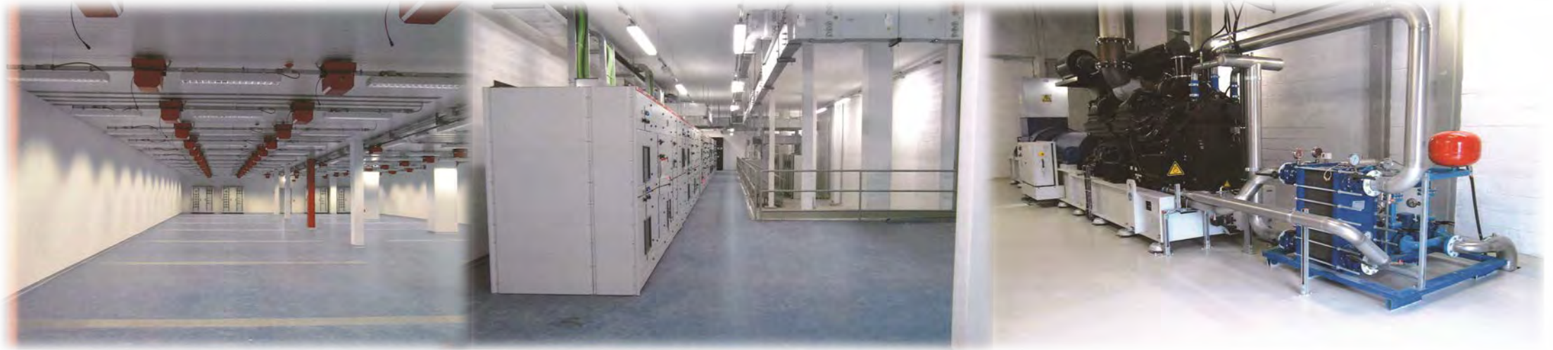
Details of the indoors and plants/ Dettagli degli interni e degli impianti
