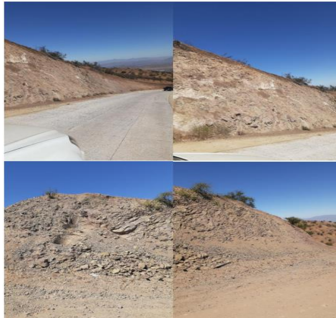
Imagen 6. Activación de procesos erosivos y remoción en masa en sectores de taludes de caminos, proyecto La Cumbre. Fuente: SAG 22 .
