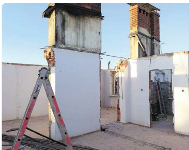
► Zostały tylko ściany zewnętrzne i kominy
