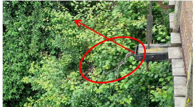
Imagen 05: Cables de acero laterales
