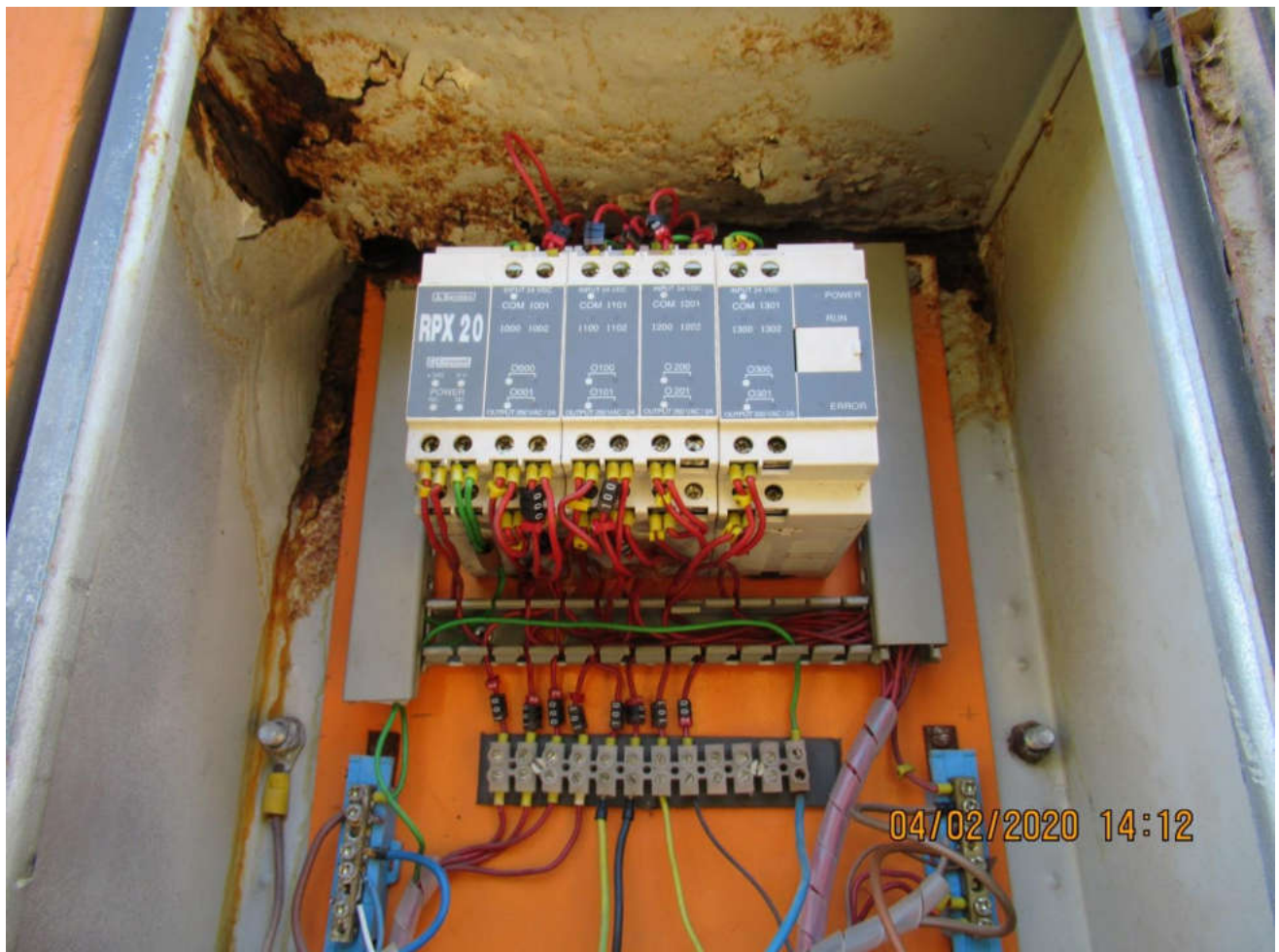
(Ηλεκτρικός πίνακας Δήμου Σκοπέλου)
