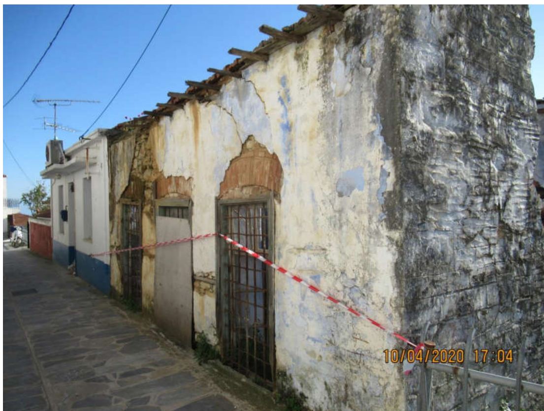
(Εργασίες για την προστασία των πολιτών από την κατάρρευση ετοιμόρροπου σπιτιού στη Γλώσσα)
