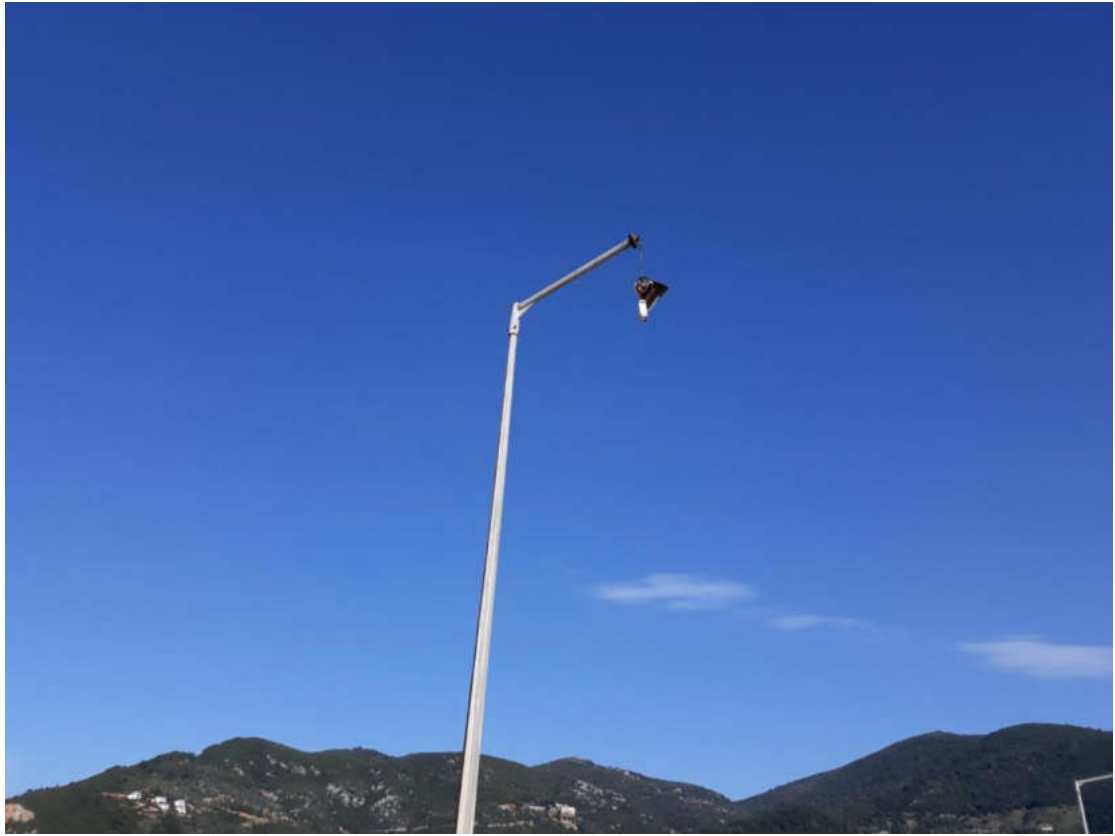
(Δημοτικός φωτισμός στο λιμένα Σκοπέλου)
