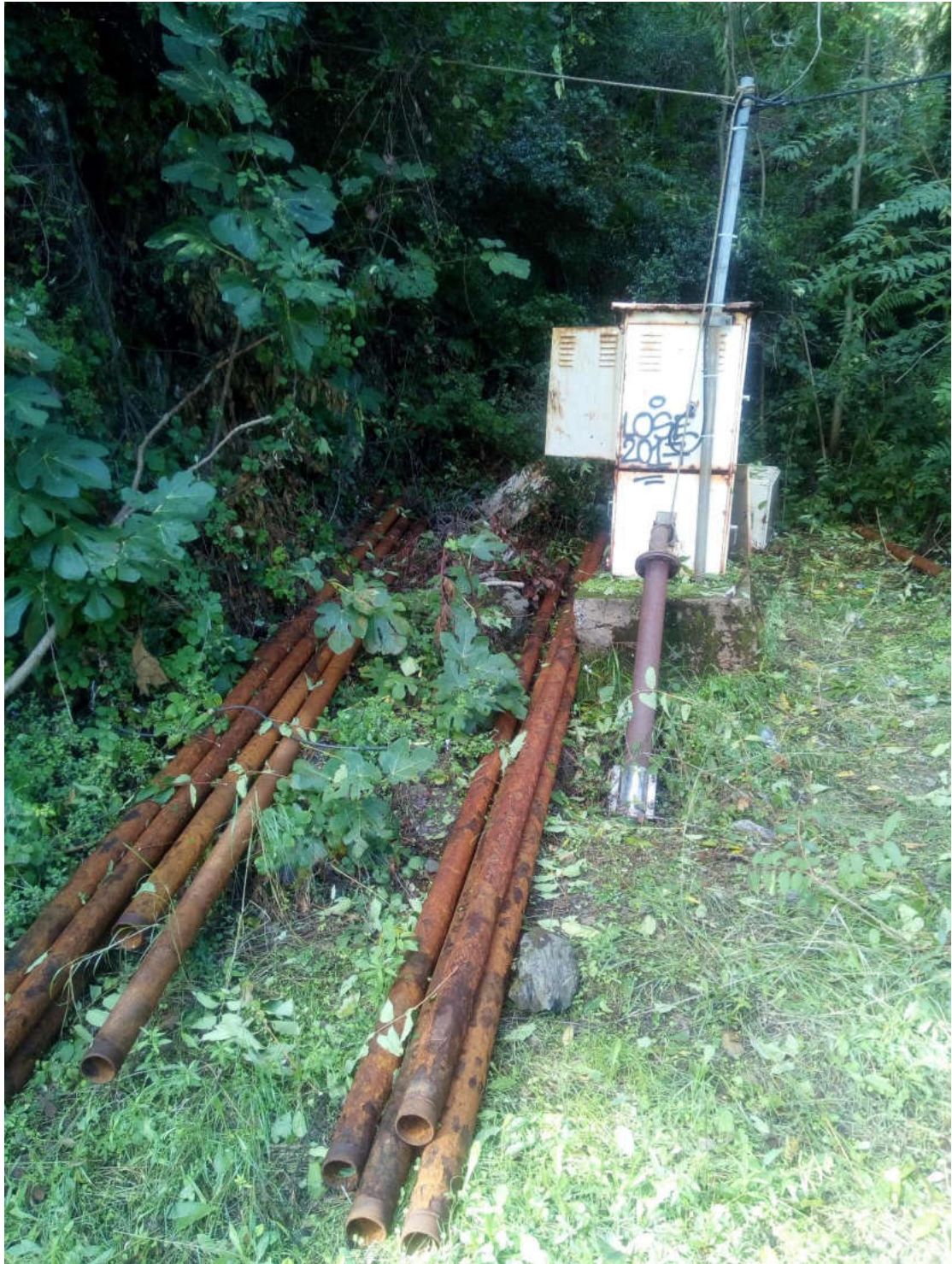
(Σωλήνες γεωτρήσεων Γλώσσας)
