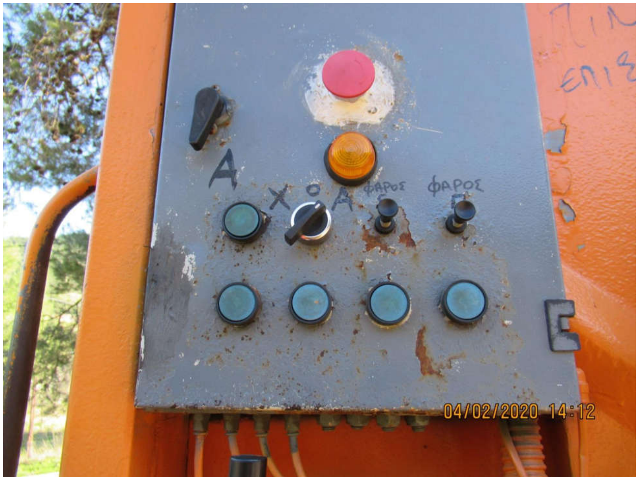
(Ηλεκτρικός πίνακας Δήμου Σκοπέλου)
