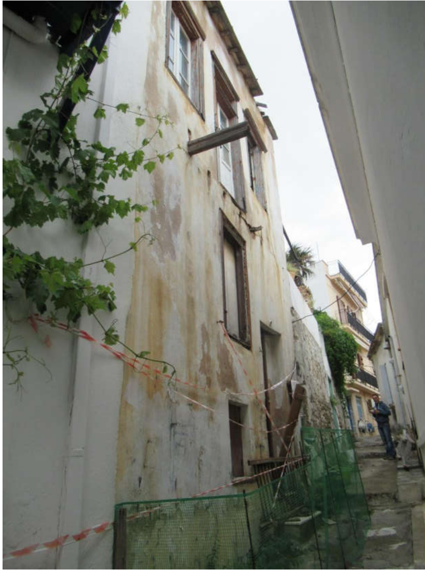
(Εργασίες αποκατάστασης ετοιμόρροπου κτιρίου στη χώρα Σκοπέλου για την προστασία των πολιτών)
