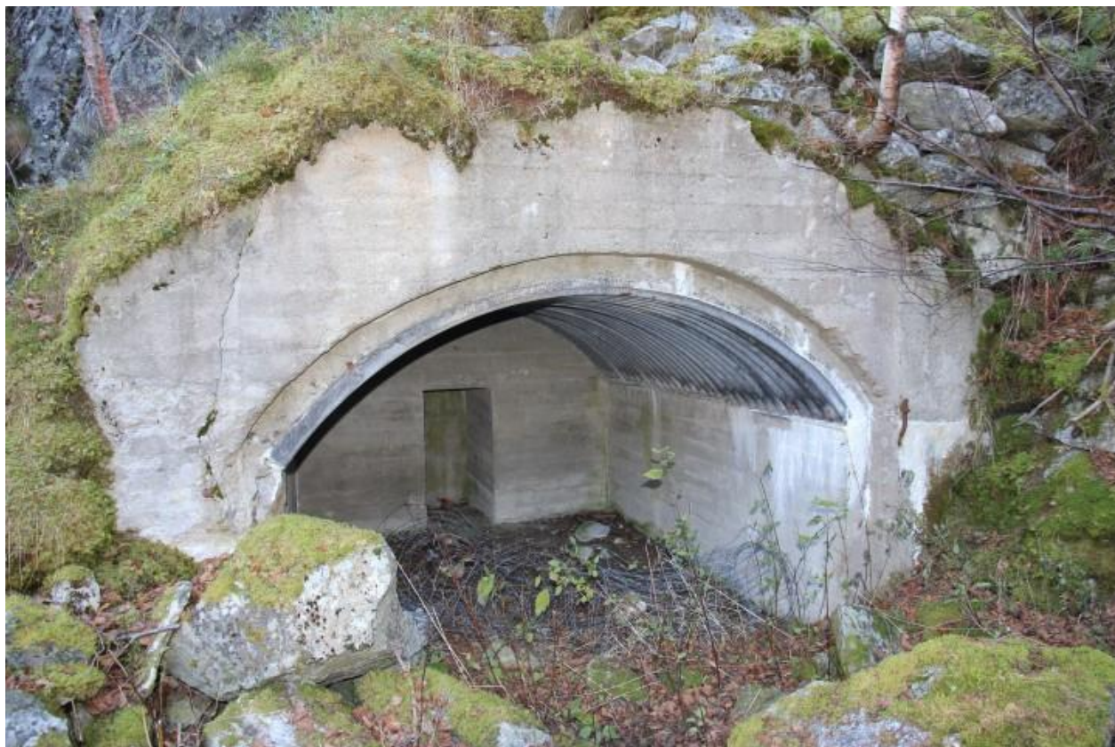
Garasje for panservernkanon på vestsiden av Otra, hengslene for portene er synlige på høyre side.
