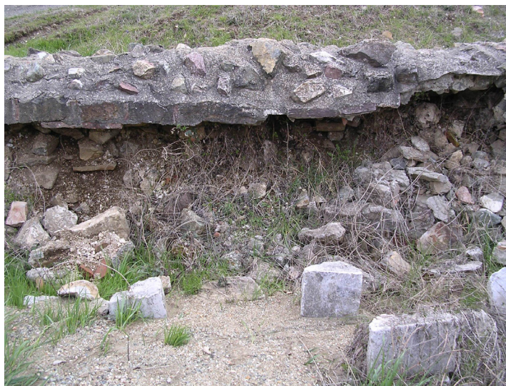
Слика 3: Урушавање оригиналних архитектонских остатака бедемског зида из доба краља Милутина у манастиру Бањска
