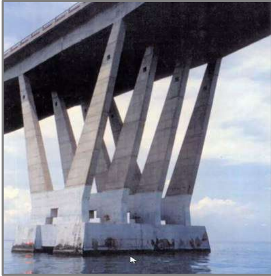
Daños en Pila 9 y Pila 10 del PGRU
