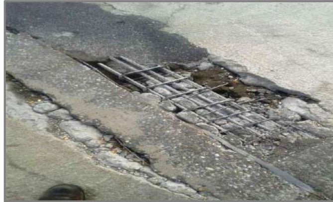
Patrón de Agrietamiento en Tableros Mixtos
