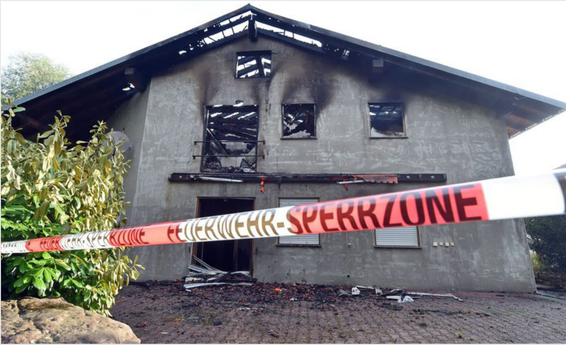
Daño de fuego en Remchingen
